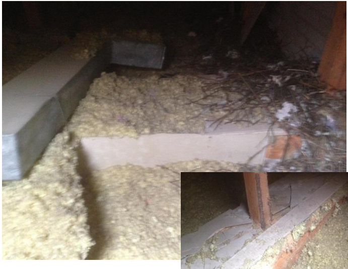
Kuva 8: Ullakkotilassa havaittiin asbestia sisältäviä kuitusementtilevytyksiä sekä iv-kanavia. IV-kanavien liitosten tiivisteet sisälsivät asbestia.
