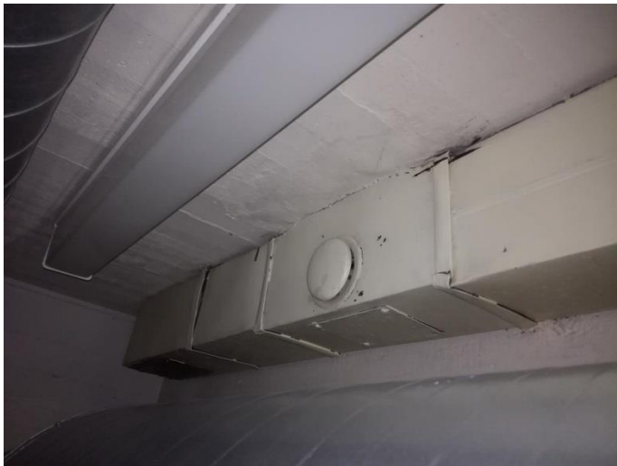
Kuva 3: Kellarikerroksessa varastotiloissa on iv-kanavia, joiden liitostiiivistemateriaali sisältää asbestia.
