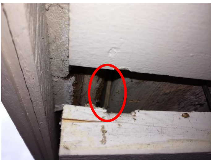
Kuva 7: Yläasteen osalla sisääntulojen ka- tosten julkisivulaudoitusten alle on asen- nettuna kuitusementtilevy, joka sisältää as- bestia.
