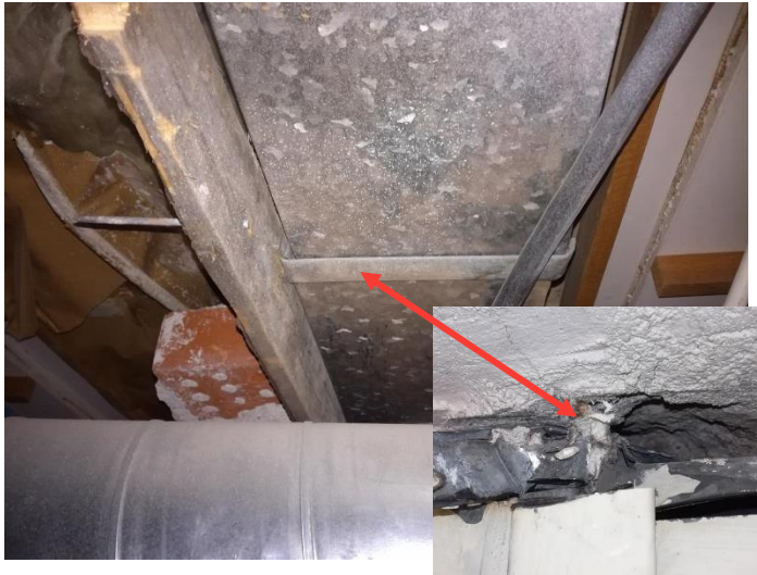
Kuva 2: Alas lasketun katon yläpuolella wc-tilojen läheisyydessä havaittiin alkuperäisiä iv-kanavia, joiden liitosten nauhatiivistemateriaali sisältää asbestia.
