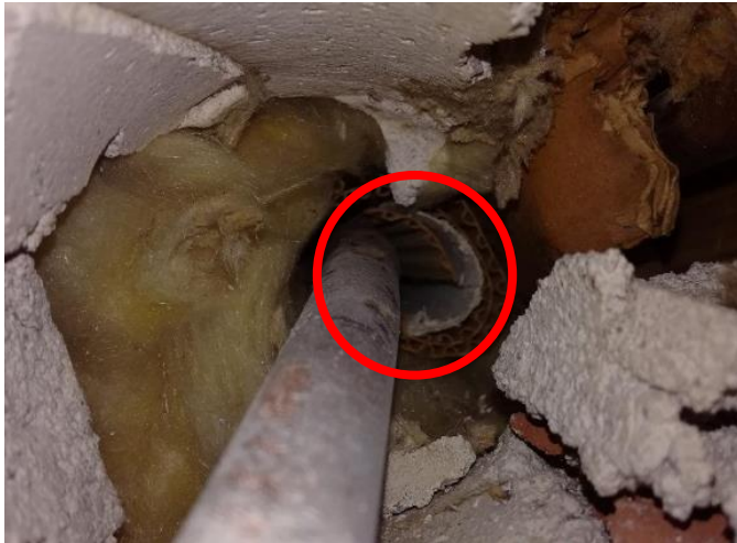
Kuva 11: Putkikanaalista alapohjarakenteisiin lähtevien putkien eristeissä havaittiin asbestia sisältävää materiaalia
