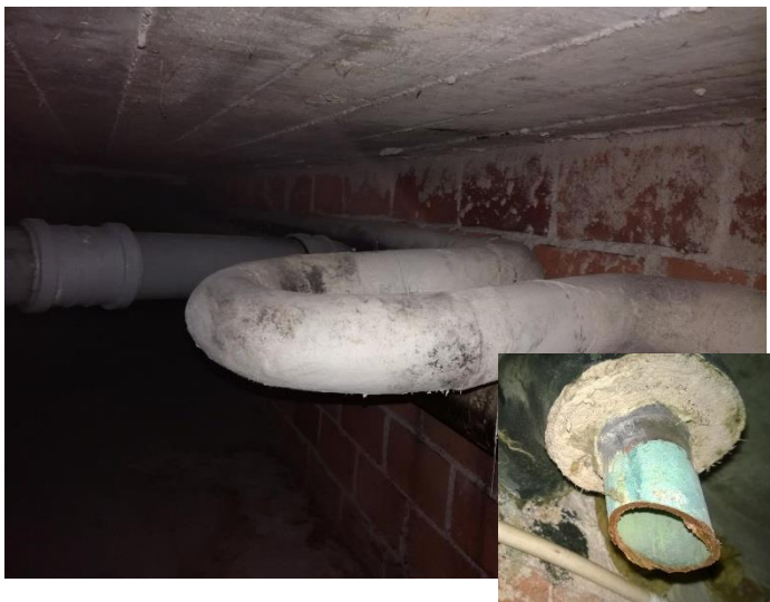
Kuva 9: Yläasteosan lattian alla olevassa kanaalissa havaittiin alkuperäisiä putkistoeristeitä, jotka sisälsivät asbestia.
