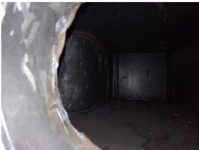
Kuva 4: Liikuntasalin yhteydessä olevien puku- ja pesutilojen iv-kanavaliitoksissa käytetty massatiivistys sisältää asbestia
