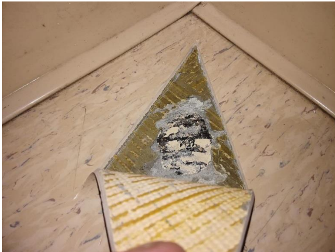
Kuva 1: Lattiarakenteissa useassa tarkastuspisteessä havaittiin nykyisten pintamateriaalien ja tasoitteen alla vanha musta liima-kerros, joka sisältää asbestia.
