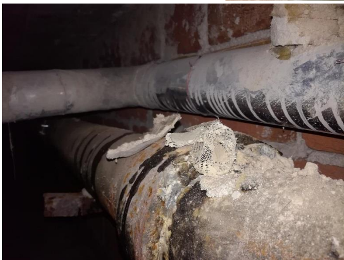
Kuva 10: Kanaalissa havaittiin purkutöiden jäljiltä putkistojen asbestieristeitä.
