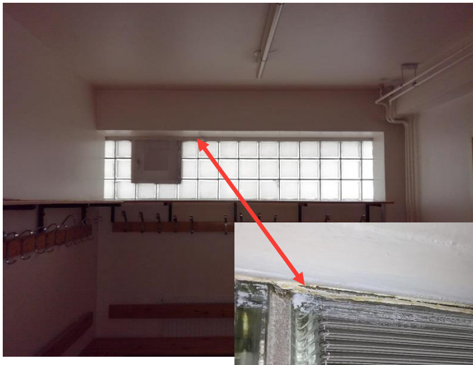
Kuva 6: Puku- ja pesutiloissa lasitiilien ja kehyksen rajapinta on tiivistetty asbestia sisältävällä materiaalilla.
