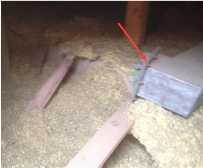
Kuva 5: Ullakkotilassa havaittiin iv-kanavia, joiden liitoksissa käytetty tiivistemateriaali sisältää asbestia
