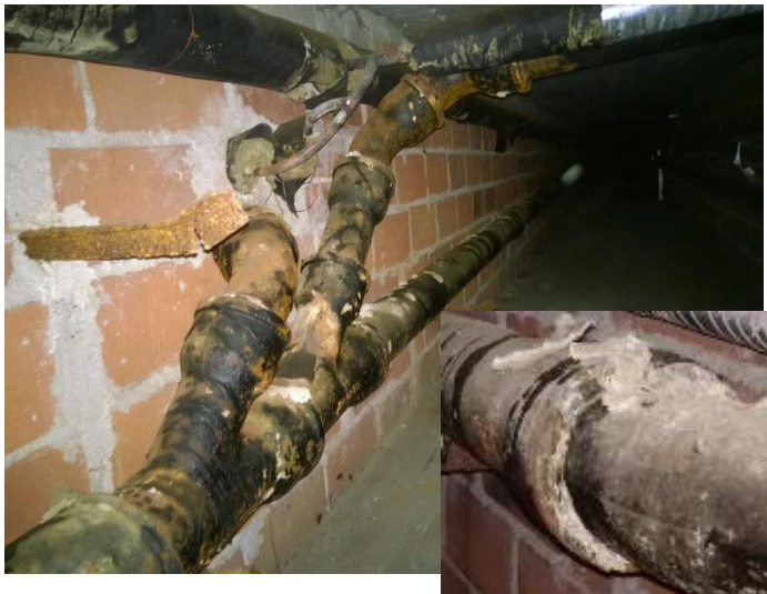
Kuva 12: Kanaaliin lattian alle on asennettu alkuperäisiä valurautaisia viemärointejä, joiden putkiliitokset sisältävät lyijyä.
