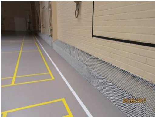
Kuva 1. Liikuntasalin patterit koteloitu teräsverkolla
