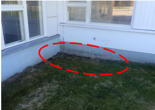
Kuva 1. Maanpinta painunut rakennuksen pohjoispuoleisella sivulla
