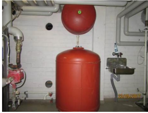
Kuva 82. Yläasteen lämmitysverkoston paisunta-astiat
