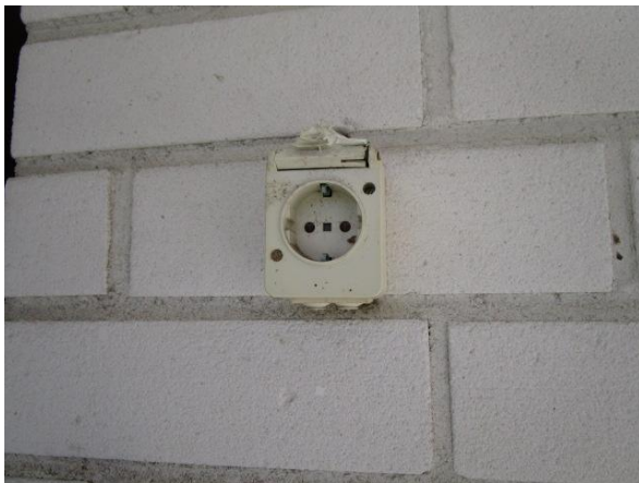
Kuva 57. Lukion ulkoseinällä on rasia rikki.
