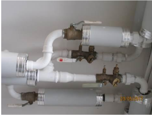
Kuva 87. Sulku- ja linjasäätöventtiili
