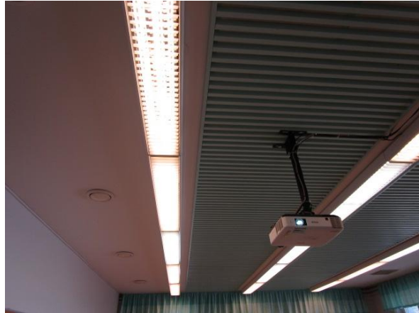
Kuva 60. Näkymä loistevalaisimista luokassa.
