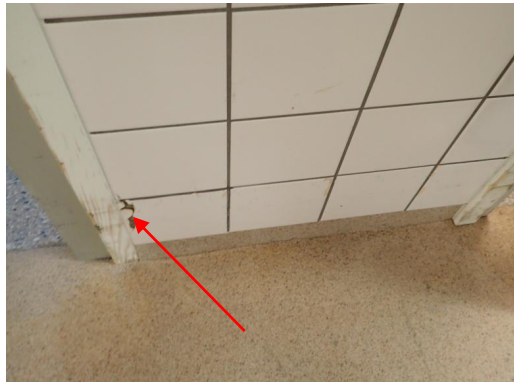
Kuva 73. Yksittäisissä seinälaatoissa halkeiluja
