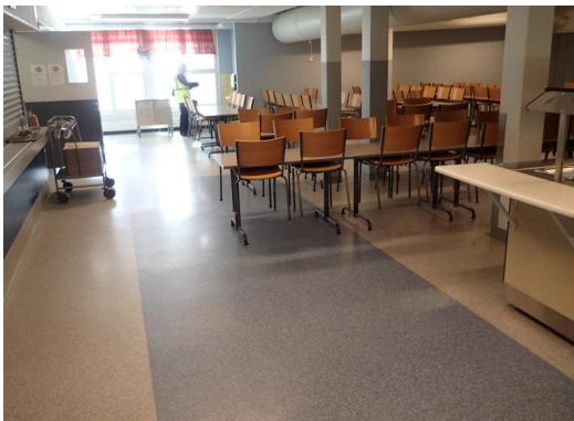
Kuva 14. Ruokalan lattian muovimatossa pintakosteudet paikoin koholla
