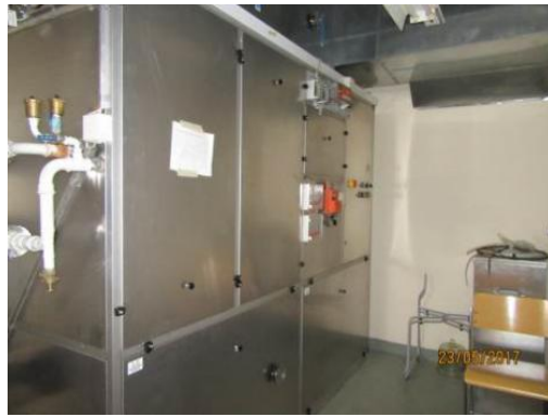
Kuva 26. Länsisiiven opetustilojen ilmanvaihtokone
