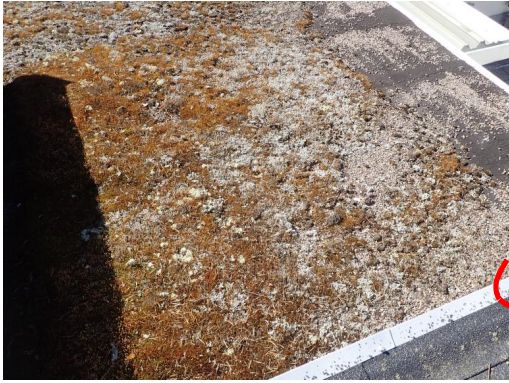
Kuva 52. Lukion ja yläasteen käytävän kohdalla vesikatteen pinnalla olevassa singelikerroksessa runsaasti sammalkasvustoa
