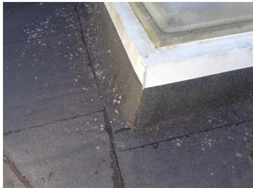
Kuva 51. Vesikatteen pinnoilla paikoin sammal- ja jäkäläkasvustoa
