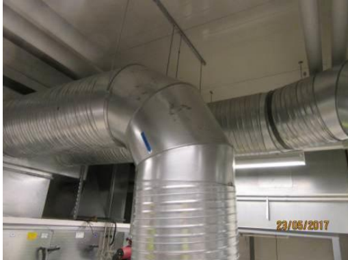
Kuva 33. Ilmanvaihtokanavat ovat hyvässä kunnossa
