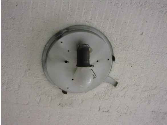
Kuva 59. Kellarin valaisimia (puuttui suojakupu).
