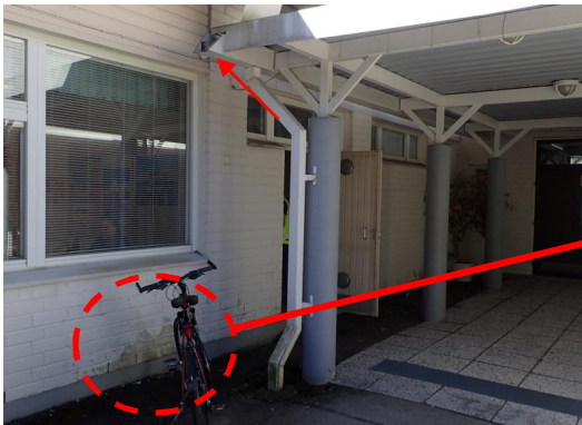
Kuva 23. Sadevesikourun vuodosta aiheutunutta vauriota julkisivun pinnalla
