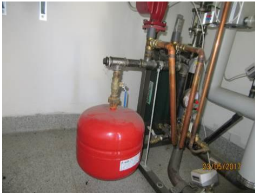
Kuva 83. Yläasteen laajennusosan iv-verkoston lämmönjakokeskus
