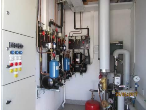
Kuva 39. Jäähdytyskompressorit laajennusosan laitetilassa
