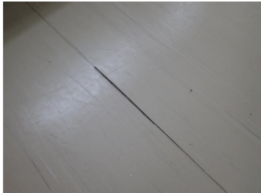
Kuva 63. Yksittäisiä rakoja muovimattojen saumauksissa
