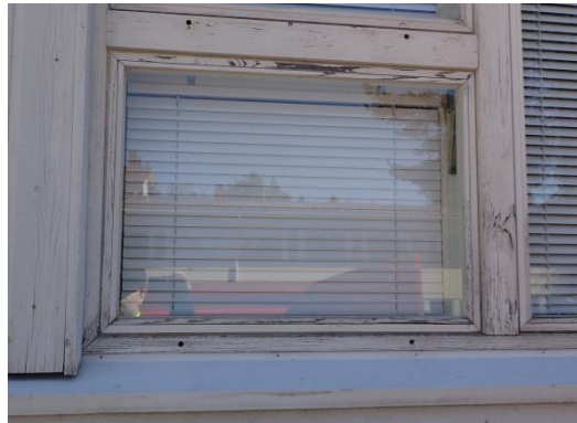
Kuva 32. Puuikkunoiden ulkopuitteissa paikoin maalipintojen kulumaa ja hilseilyä
