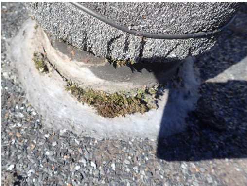
Kuva 50. Läpivientien tiivistykset ovat huonokuntoiset
