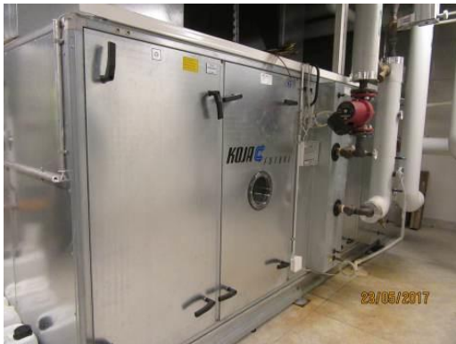
Kuva 25. Ruokasalin ja keittiön ilmanvaihtokone
