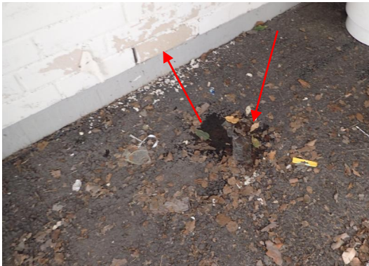
Kuva 25. Sadevesikourun vuodon roiskevedet ovat vaurioittaneet julkisivun pintaa
