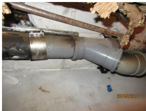
Kuva 16. Valurautaviemäriin liitetty muoviviemäri
