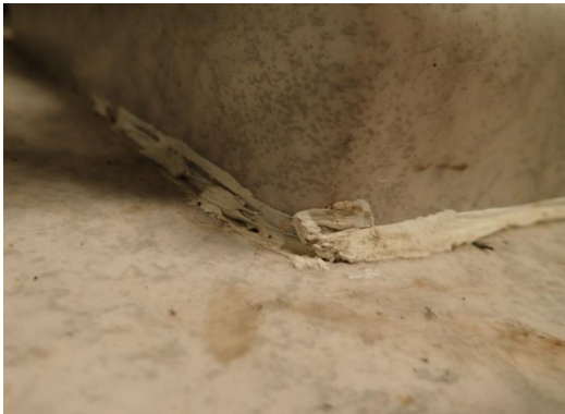
Kuva 66. Lattiamaton tiivistyksissä paikoin puutteita
