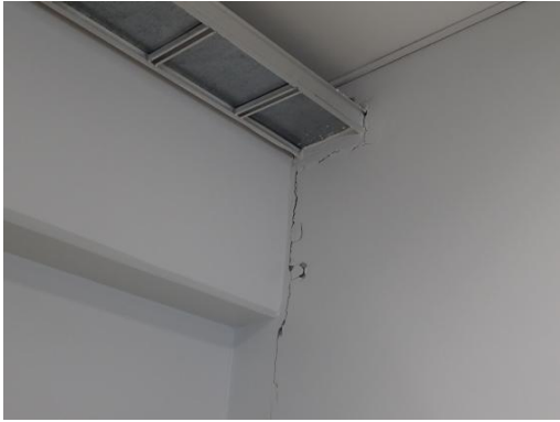
Kuva 64. Lukion luokassa 117 seinässä halkeama
