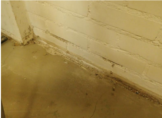
Kuva 68. Kosteusarvot paikoin koholla kellarin lattiaanrajassa
