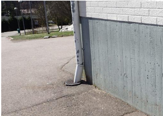
Kuva 8. Kattosadevedet on ohjattu rännikaivoihin
