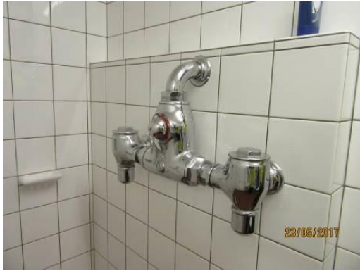
Kuva 7. Liikuntasalin suihkujen termostaattinen säätöventtiili
