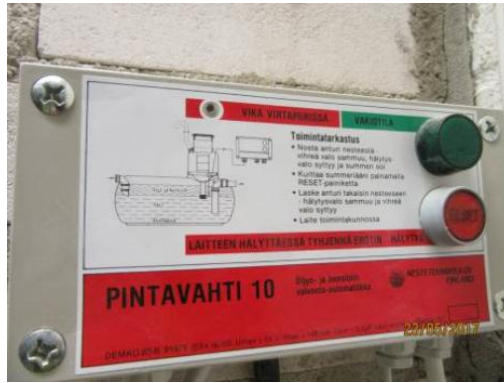
Kuva 20. Öljynerotuskaivon öljytilan täyttymishälytin
