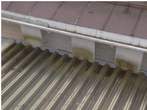
Kuva 38. Lukion sisäänkäyntikatosten pinnoilla paikoin sammalkasvustoa
