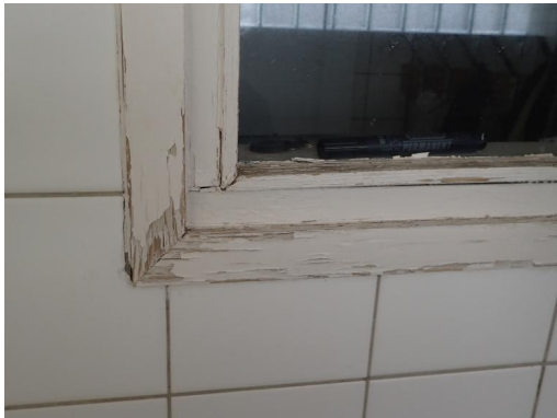
Kuva 79. Pesuhuoneessa olevan ikkunan puuosissa vaurioita
