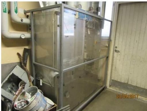
Kuva 29. Teknisen työn opetustilojen ilmanvaihtokone
