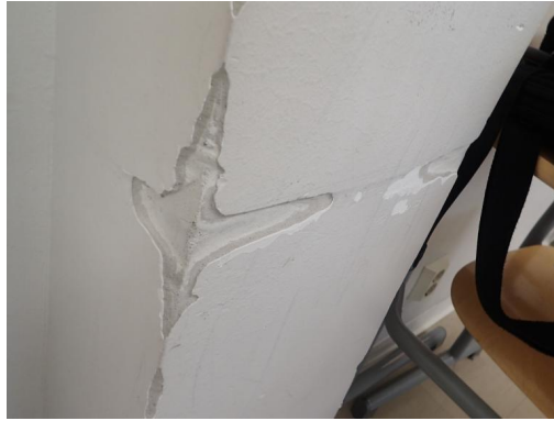
Kuva 65. Pulpettien reunoista aiheutuneita vaurioita rappauspinnoilla
