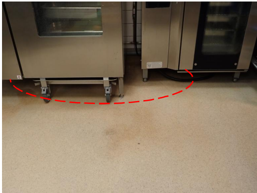
Kuva 72. Vedet lammikoituvat lattialle uunien kohdalla
