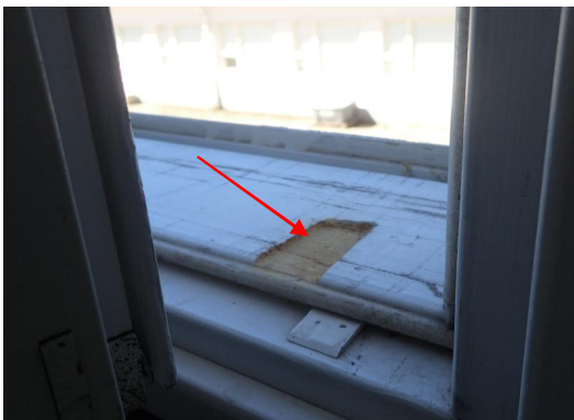
Kuva 33. Ikkunakarmeissa paikoin jälkiä puutteellisesta käynnistä
