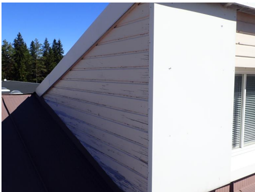
Kuva 47. Lautaverhouksien maalipinnoitteet hilseilleet kattolyhtyjen kohdalla
