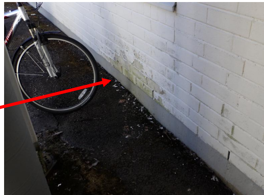
Kuva 24. Julkisivun pinnoite hilseilyt
