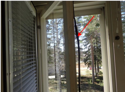
Kuva 31. Puuikkunan tiiviste irti
