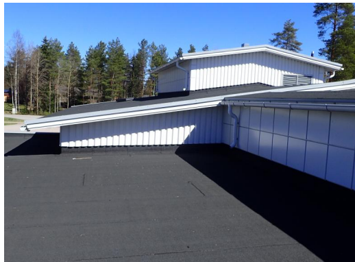
Kuva 55. Keittiön laajennuksen kohdalla korkeammille katto-osuuksille ei ole tikkaita
