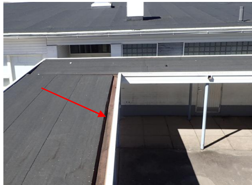
Kuva 39. Yläasteen katosten sadevesikouruissa korroosioaurioita
