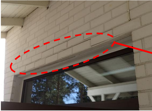
Kuva 26. Lukion itäpäädyn ovien yläpuolella tiilissä halkeiluja
