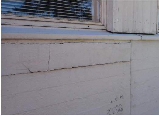
Kuva 21. Julkisivuissa paikoin halkeilua
