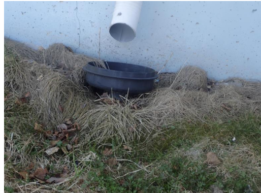
Kuva 9. Rännikaivo huonosti paikallaan
