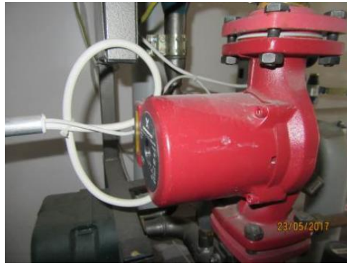
Kuva 84. Yläasteen laajennusosan iv-verkoston kiertovesipumppu
