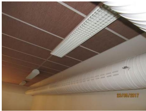
Kuva 38. Tuloilman suutinkanava ruokasalissa
