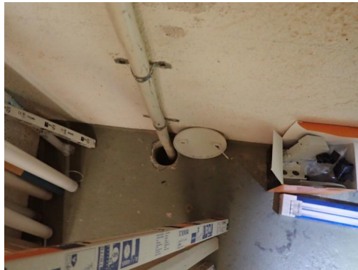
Kuva 67. Epätiivis lattialäpivienti sähköpääkeskuksessa
