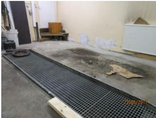
Kuva 19. Öljynerotuskaivo rasvamontun pohjalla
