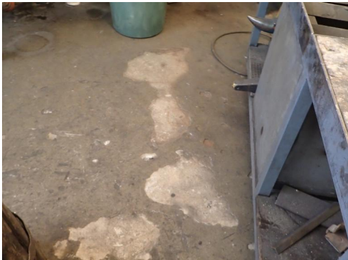
Kuva 62. Hitsaushuoneen lattiapinnoitteessa vaurioita
