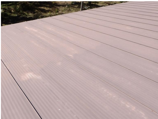
Kuva 45. Vesikatteen pinnoite haalistunut
