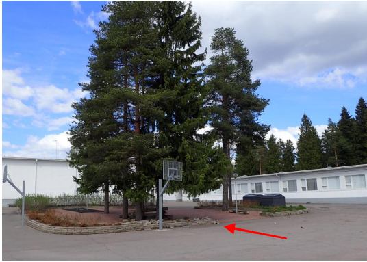
Kuva 3. Sisäpihan betonikivetty alue. Muurirakenne paikoin huonokuntoinen.
