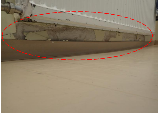
Kuva 12. Luokassa 17 kosteusvaurioita lattia-rajassa
