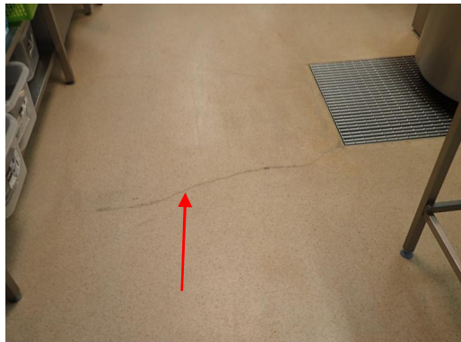
Kuva 71. Keittiön lattiapinnoitteessa paikoin halkeilua
