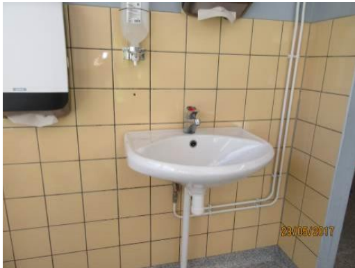
Kuva 9. Vesijohdot ovat kunnossa
