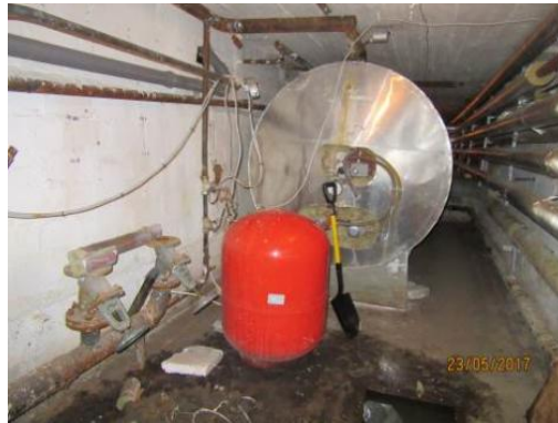
Kuva 4. Varaajasäiliö ym. putkitunnelissa
