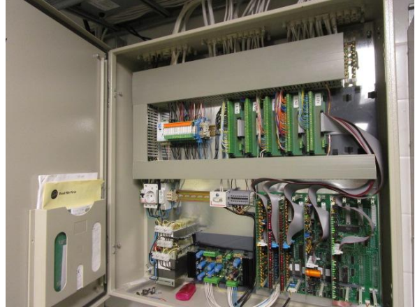
Kuva 74. Näkymä automaatiokeskuksesta, keittiö.
