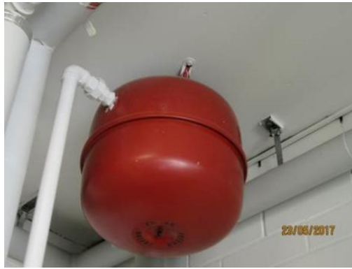
Kuva 86. Lukion lämmitysverkoston paisunta-astia
