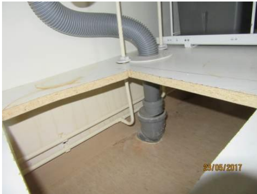
Kuva 11. Viemärit tulisi jatkaa kalusteen pohjan yläpuolelle
