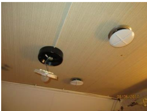
Kuva 102. Painovoimaisen ilmanvaihdon poistoilmaventtiilit
