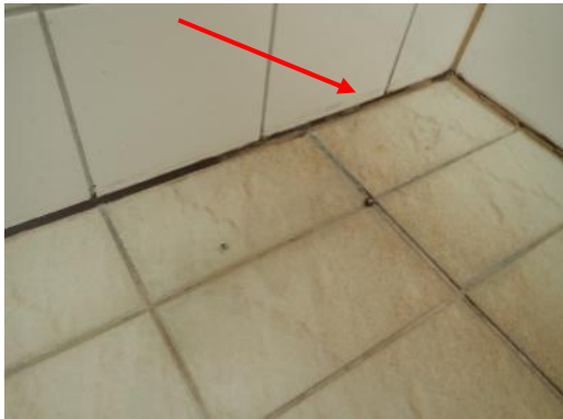
Kuva 73. Silikonisaumat paikoin huonossa kunnossa
