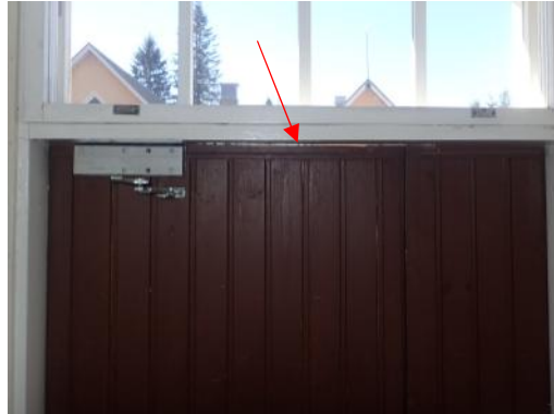
Kuva 35. Ulko-ovien tiivistyksissä puutteita
