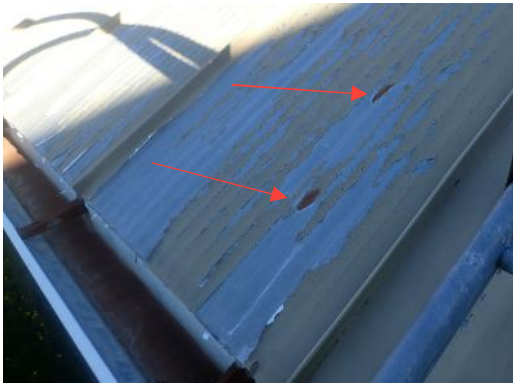
Kuva 48. Katteen pinnoite irtoillut, yksittäisiä ruostevaurioita
