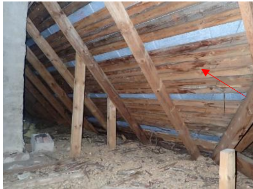
Kuva 53. Yleiskuuvaa yläpohjasta, kosteuden aiheuttamia jälkiä
