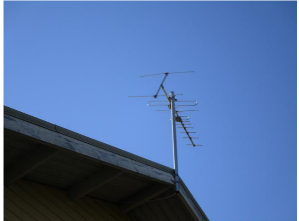
Kuva 125. Näkymää antennilaitteesta katolla.
