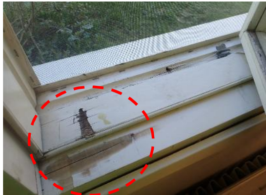
Kuva 33. Puutteellisen käyntisovituksen aiheuttamia jälkiä
