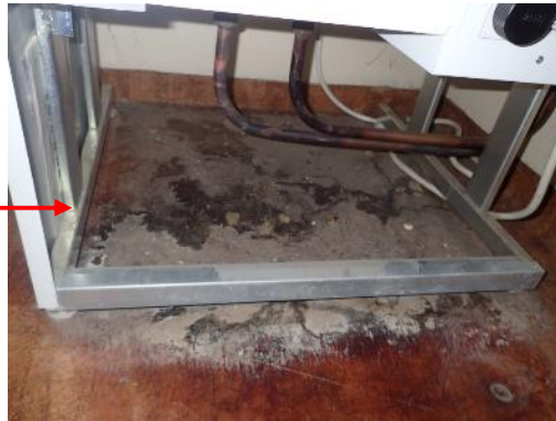
Kuva 78. Vesivaraajan alla vuotoveden aiheuttamia vaurioita
