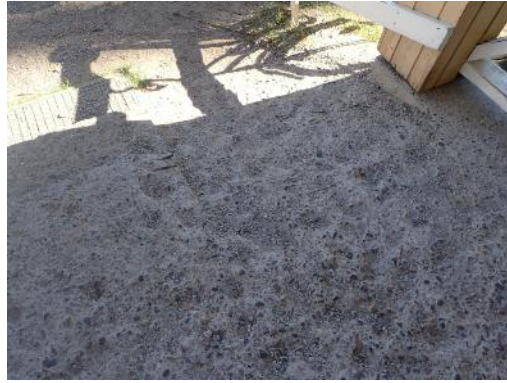
Kuva 43. Katoksen kaiteiden maalipinnoitteet ovat kuluneet
