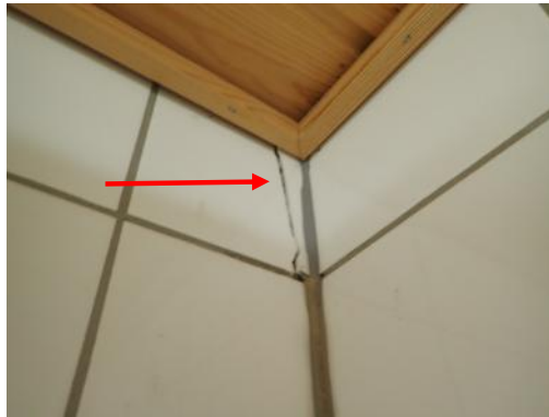
Kuva 74. Yksittäisiä haljonneita laattoja seinissä
