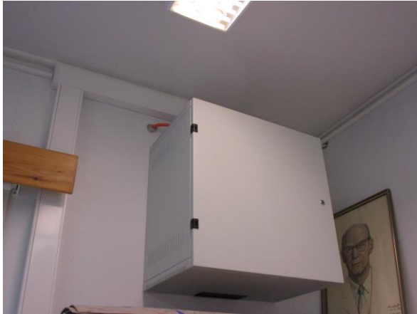
Kuva 124. ATK-/ telejakamokaappi, luokassa.
