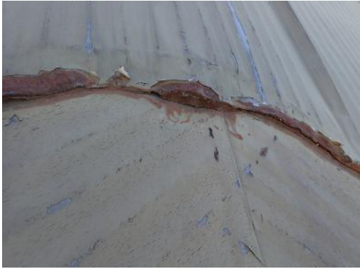
Kuva 46. Vesikatteen saumakohdissa yksittäisiä ruostevaurioita
