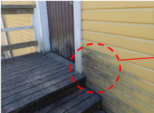
Kuva 23. Julkisivulaudoituksessa paikoin lahovaurioita
