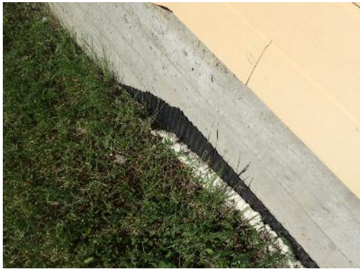
Kuva 7. Lisärakennuksen vierustalla patolevy
