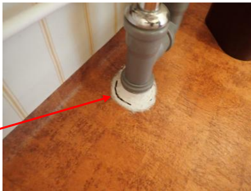
Kuva 76. Viemäriläpiviennin tiivistys puutteellinen
