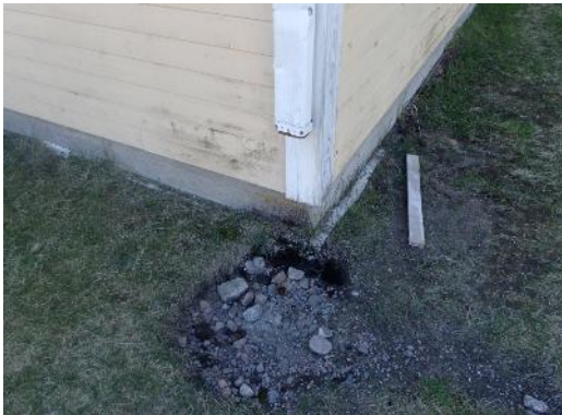
Kuva 15. Syöksyputken alaosa puuttuu
