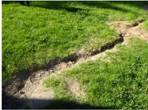
Kuva 14. Sadevedet ovat aiheuttaneet railoja
