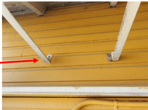
Kuva 56. Talotikkaiden yläpään kiinnitys osittain irti
