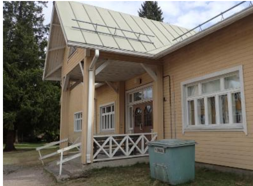
Kuva 41. Katoksen kaiteiden maalipinnoitteet ovat kuluneet
