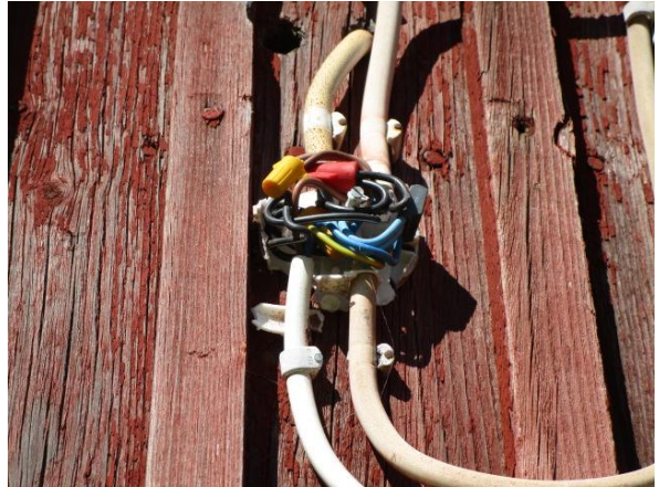
Kuva 113. Ulkoseinällä asennuksia rikki.
