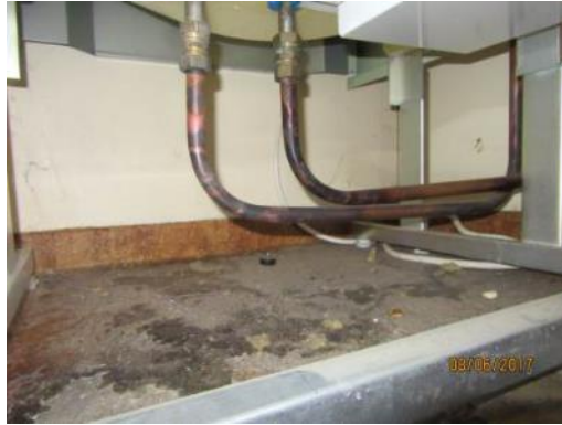
Kuva 85. Kupariputket vanhan puolen lämminvesivaraajan alapuolella
