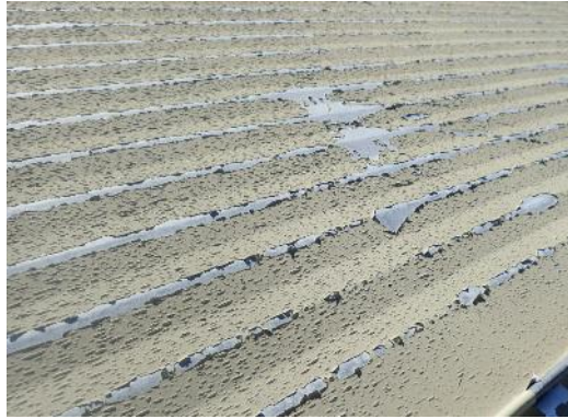
Kuva 47. Vesikatteen pinnoite monin paikoin huonokuntoinen
