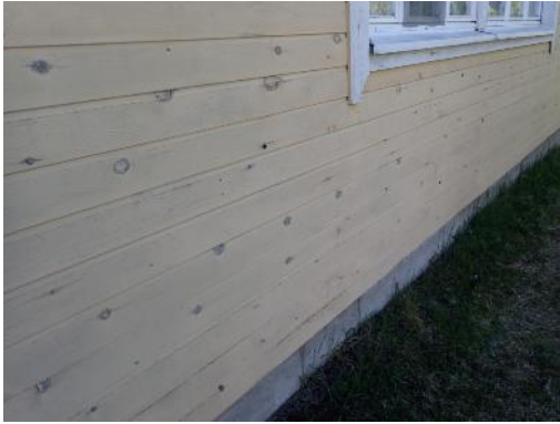
Kuva 27. Julkisivupaneloinnin maalipinnoitteet paikoin kuluneet
