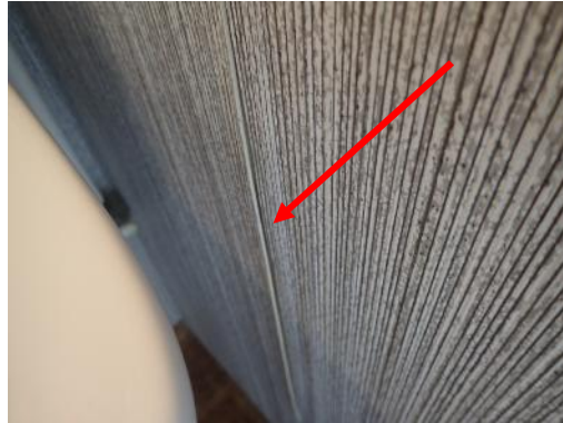
Kuva 70. Wc-tilan muovitapettien saumat ovat paikoin auki
