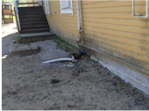
Kuva 12. Sadevesiputkien kaadoissa puutteita
