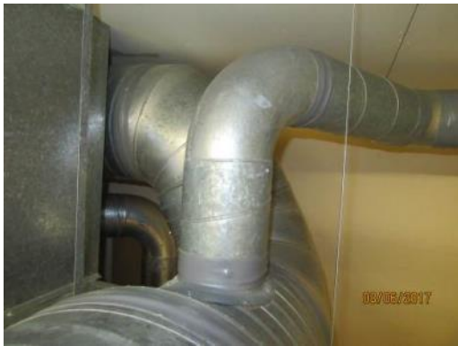
Kuva 98. Ilmanvaihtokanavat ovat kunnossa
