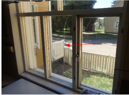
Kuva 29. Kiinteitä puuikkunoita. Keskimmäisen ikkunan lasi rikki.
