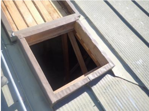
Kuva 59. Kattoluukussa ei ole kannen putoamisen estävää ketjua
