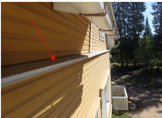
Kuva 25. Lisälämmöneristyksen ja yläpohjan rajakohdassa pelti
