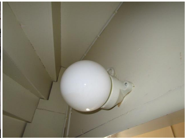
Kuva 119. Näkymä alkuperäisistä valaisimista.
