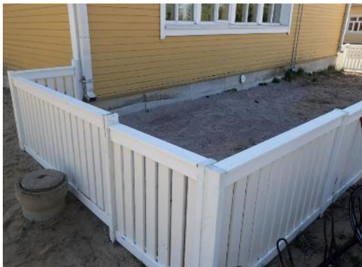
Kuva 18. Puinen aita rakennuksen vierustalla
