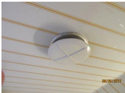
Kuva 103. Painovoimaisen ilmanvaihdon poistoilmaventtiili
