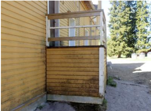
Kuva 40. Pohjoispuolen portaiden puuverhous huonokuntoinen
