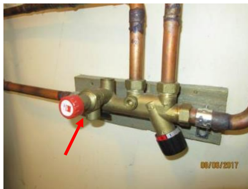
Kuva 83. Vanhan puolen lämminvesivaraajan varoventtiili
