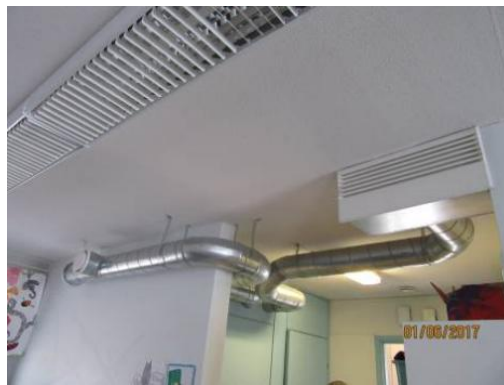
Kuva 31. Päiväkodin tulo- ja poistoilmaventtiili
