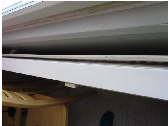
Kuva 53. Kaapelikourun kiinnitys on heikko.
