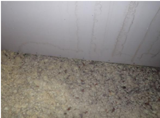
Kuva 40. Valokuilun seinärakenteessa valumajälkiä yläpohjan eristeeseen asti
