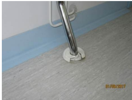
Kuva 9. Rikkiöitynyt vesilukon liitosyhteys
