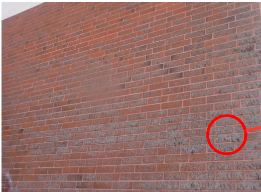
Kuva 19. Liikuntasalin luoteispään seinässä runsaasti jäkäläkasvustoa
