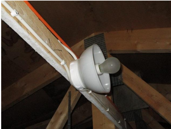
Kuva 54. Ullakon valaisimia (puuttui suojakupu).
