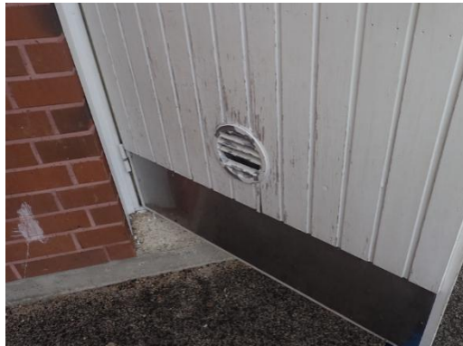
Kuva 27. Yksittäiset ulko-ovet ovat puupintaisia. Ulko-ovien puuosien maalipinnat olivat kuluneet
