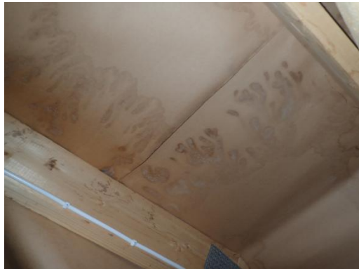
Kuva 41. Aluskatteen pinnoilla monin paikoin havaittavissa kosteusjälkiä
