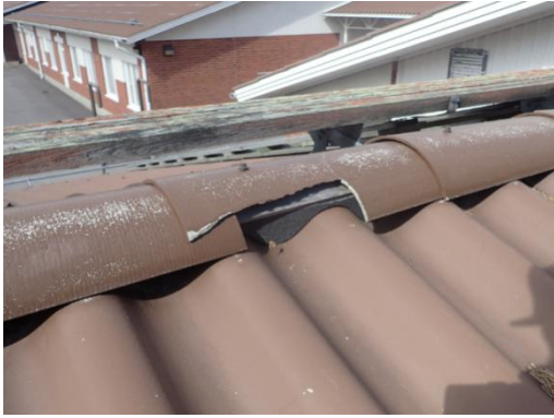
Kuva 34. Vesikatteessa paikoin lohkeilua
