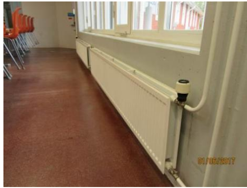
Kuva 63. Lämmityspatteri ja termostaattinen patteriventtiili
