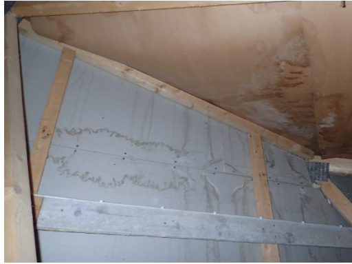
Kuva 39. Valokuilun seinäpinnoilla monin paikoin kosteusjälkiä
