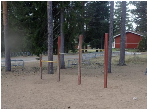
Kuva 5. Leikkivälineiden maalipinnoitteet ovat kuluneet
