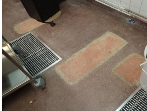
Kuva 50. Keittiön lattiapinnoitteessa paikkakorjauskohtia
