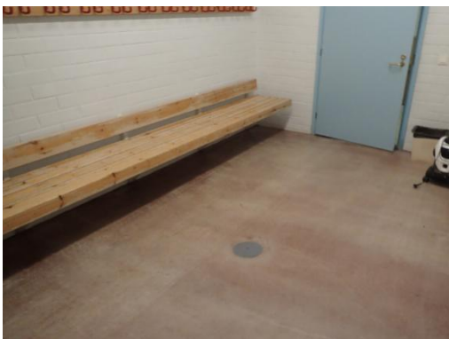
Kuva 54. Yleiskuva pukuhuoneesta, lattiapinnoite haalistunut
