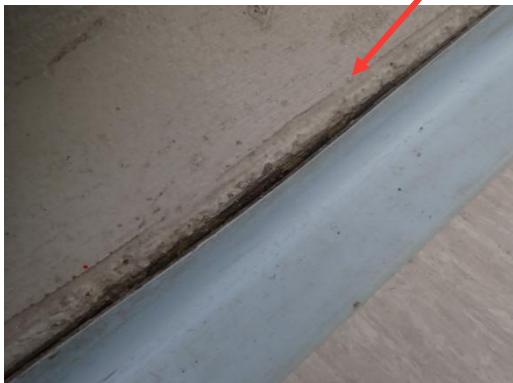
Kuva 48. Lattialista liimaus paikoin irronnut
