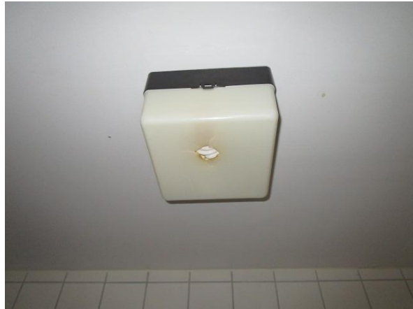
Kuva 55. Tilan 514 valaisin kupu on palanut osittain.
