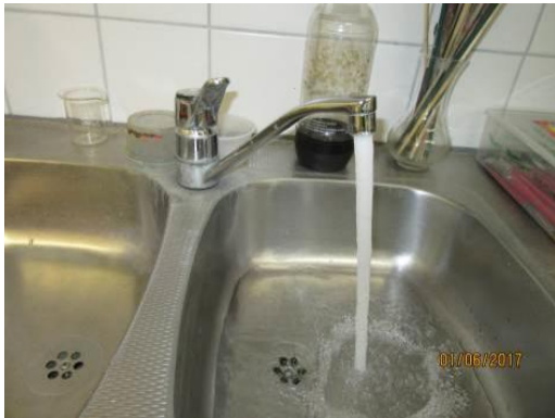
Kuva 6. Vesikalusteet ovat kunnossa
