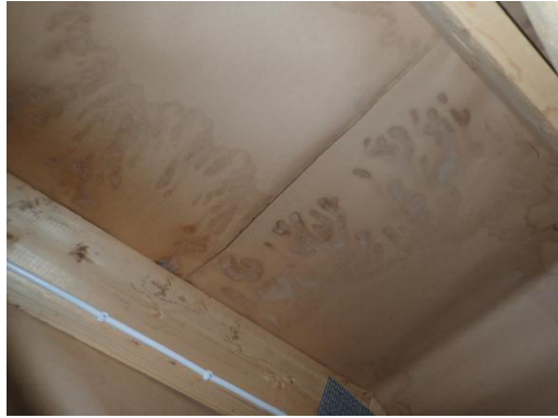
Kuva 35. Aluskatteen pinnoilla monin paikoin havaittavissa kosteusjälkiä
