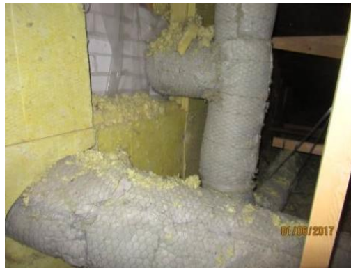
Kuva 25. Ilmanvaihtokanavien eristykset ovat kunnossa ja riittävät
