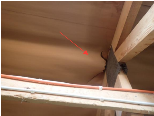
Kuva 36. Aluskatteessa paikoin reikiä
