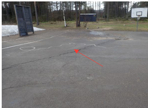
Kuva 2. Asfalttoinneissa paikoin halkeiluja
