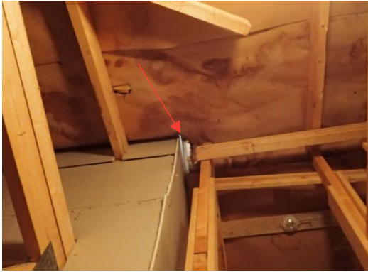
Kuva 38. Vesikatteessa paikoin aukkoja
