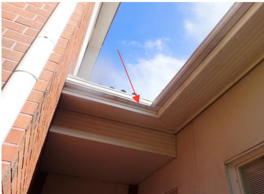
Kuva 10. Liikuntasalin kohdalla sadevesikourussa vuoto
