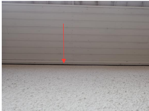
Kuva 37. Yläpohjan tuuletus paikoin niukka
