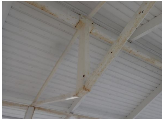
Kuva 31. Katosten teräsosien pinnoissa monin paikoin korroosioaurioita
