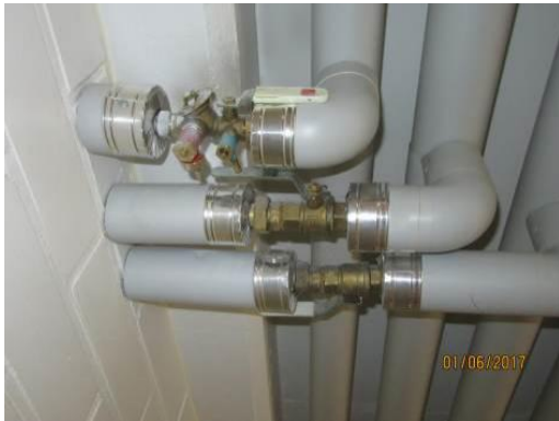
Kuva 4. Sulku- ja linjasäätöventtiilit
