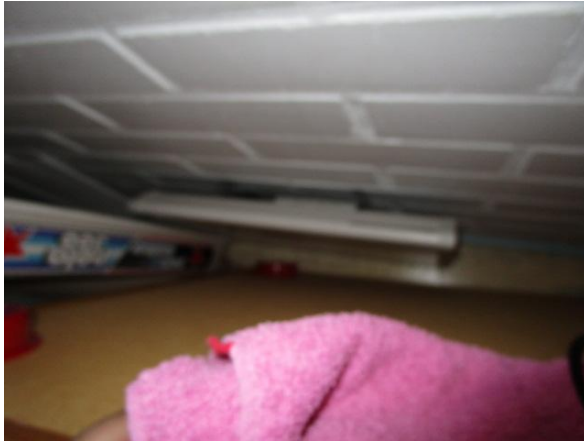
Kuva 58. Lämmittimen edessä on tavaroita (palovaara)
