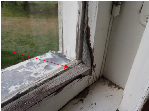
Kuva 34. Kolmipuitteisen puuikkunan uloimmassa puitteessa maalipinta irronnut
