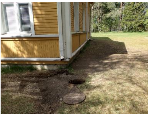
Kuva 11. Salaojan tarkastuskaivo keltaisen rakennuksen vieressä
