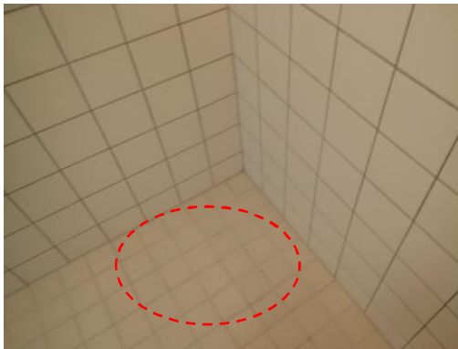
Kuva 77. Tyttöjen pesuhuoneen nurkassa yksittäisiä alustastaan irti olevia laattoja
