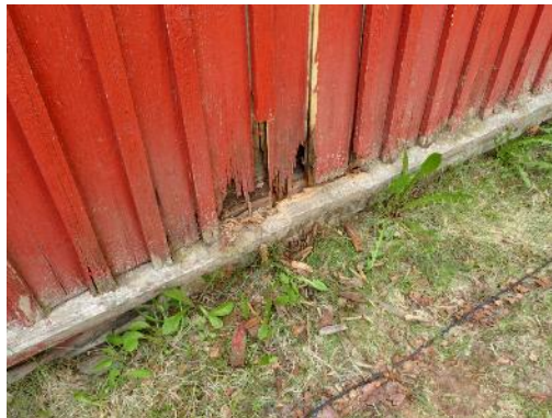
Kuva 23. Lahovaurioita punaisen rakennuksen alimmissa hirsissä
