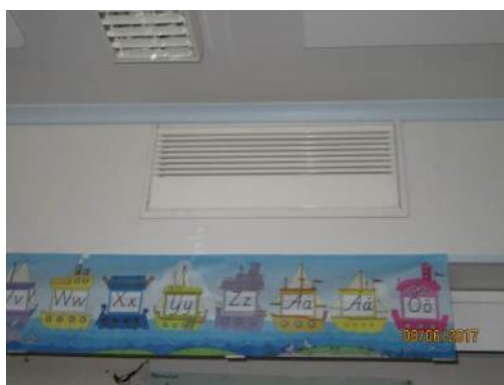
Kuva 66. Monitoimitalon opetustilan tuloilmaventtiili
