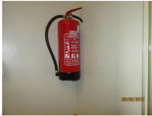
Kuva 68. Käsiammutin punaisessa rakennuksessa.
