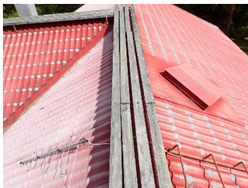
Kuva 62. Puiset kattosillat ovat ikääntyneet keltaisen rakennuksen katolla
