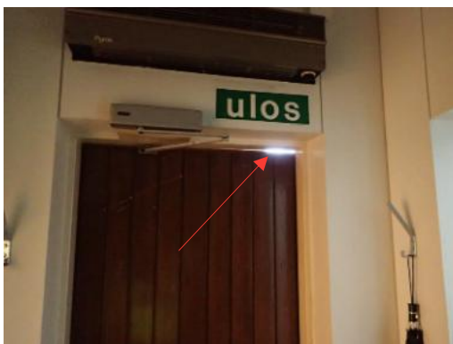
Kuva 39. Punaisen rakennuksen ulko-oven ja karmin välissä rako
