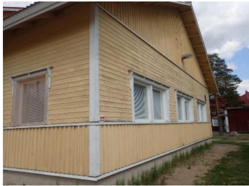
Kuva 25. Monitoimitalon puuverhouksen maalipinnat ovat kuluneet
