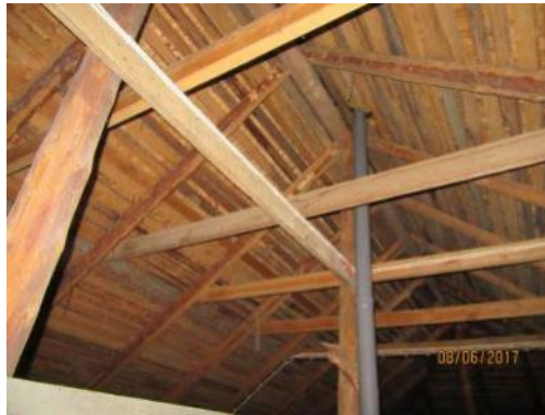
Kuva 54. Tuuletusviemäri punaisen talon ullakolla
