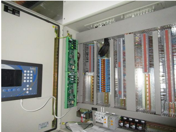
Kuva 124. Näkymä automaatiolaitteesta (Monitoimitalo).
