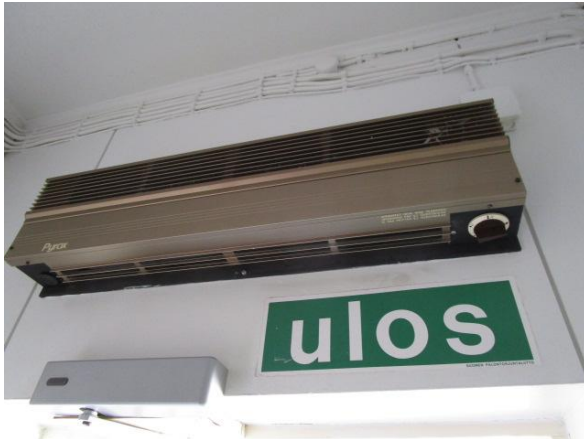
Kuva 116. Lämmittimiä oviaukoissa, koulu
