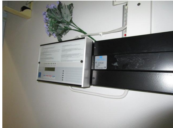
Kuva 125. Näkymää automaatio kello-ohjaimesta.
