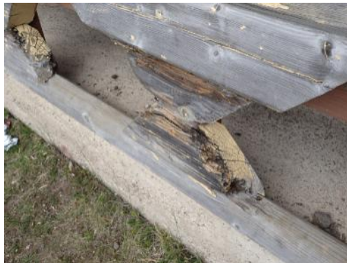
Kuva 19. Katoksen puuosissa paikoin vaurioita
