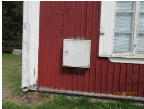
Kuva 70. Ulkopaloposti punaisessa rakennuksessa.
