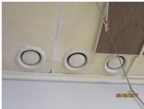
Kuva 64. Poistoilmaventtiilit punaisessa rakennuksessa
