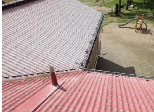
Kuva 51. Vesikatteen pinnoite haalistunut
