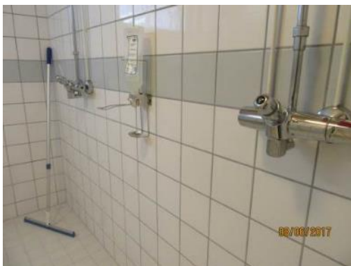
Kuva 97. Vesikalusteet ovat kunnossa
