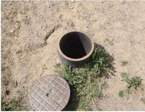
Kuva 13. Monitoimitalon vierellä salaojan tarkastuskaivo noussut
