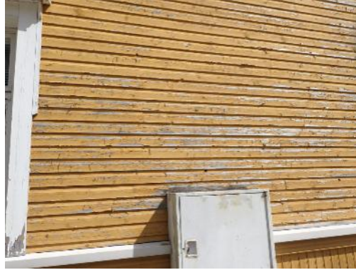
Kuva 29. Keltaisen rakennuksen julkisivujen maalipinnoite kulunut
