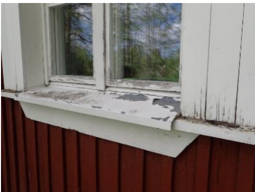
Kuva 36. Ikkunapeltien maalipinnoitteet monin paikoin kuluneet
