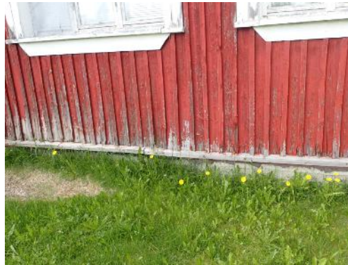
Kuva 31. Julkisivulaudoitusten alareunat huonokuntoiset
