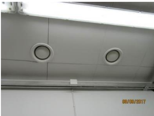
Kuva 63. Poistoilmaventtiilit keltaisessa rakennuksessa
