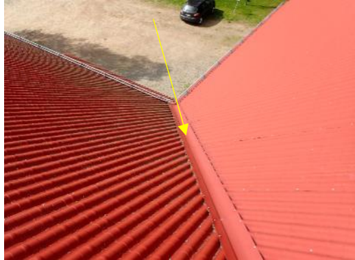
Kuva 57. Jiiripelti asennettu virheellisesti vesikatteen päälle
