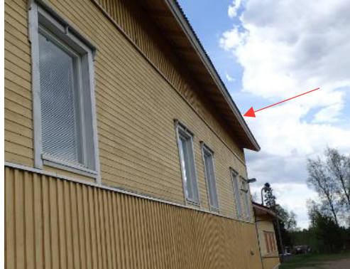
Kuva 10. Monitoimitalon lännenpuoleiselta lappeelta puuttuu sadevesijärjestelmä
