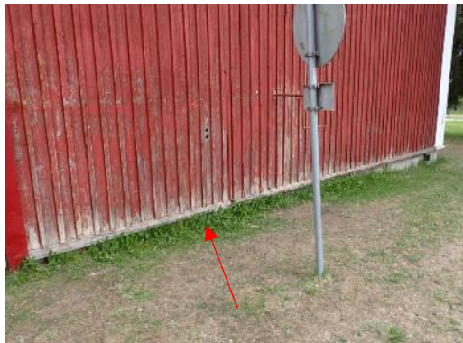
Kuva 4. Sokkeleita ei paikoin näy ollenkaan
