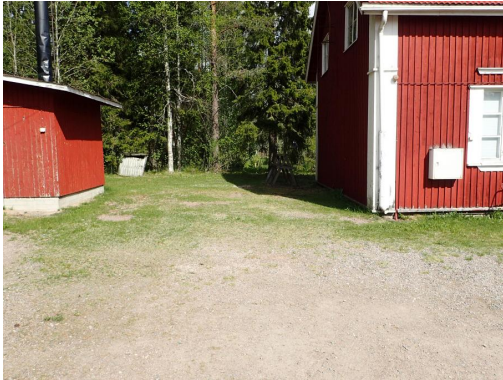
Kuva 5. Maanpintojen kallistuksessa puutteita
