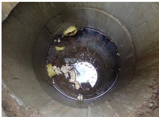
Kuva 12. Tarkastuskaivossa vettä ja styroxinpaloja
