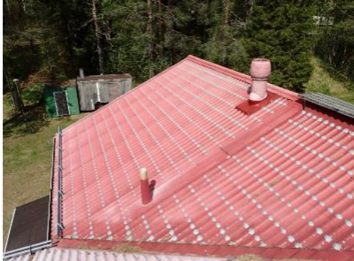
Kuva 50. Yleiskuva keltaisen rakennuksen vesikatteesta. Vesikatteen pinnoite kauttaaltaan kulunut
