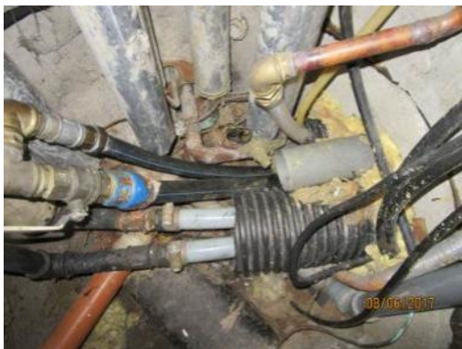
Kuva 89. Lämpöjohtojen lähtö lämpökeskuksesta
