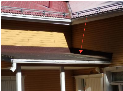
Kuva 42. Keltaisen rakennuksen katoksen vesikatteessa vähäistä jäkälä/sammalkasvustoa
