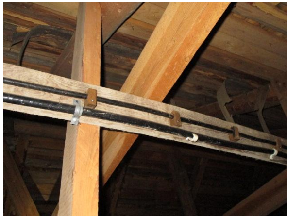
Kuva 109. Ullakon vanhoja kaapeliasennuksia.
