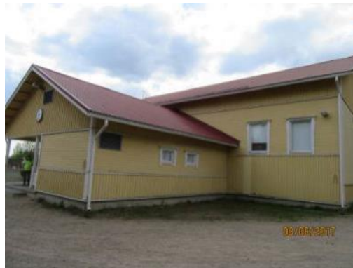
Kuva 56. Syöksyputkien alla ei ole rännikaivoja
