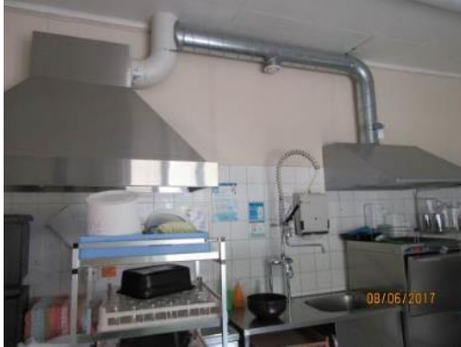
Kuva 61. Ilmanvaihtokanavat ja keittiön höyrykuvut
