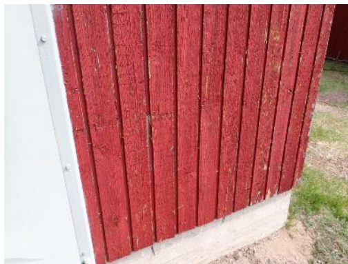
Kuva 21. Lämmönjakokeskuksen maalipinnoitteet kuluneet
