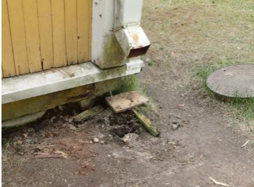
Kuva 9. Vesien aiheuttamia vaurioita keltaisen rakennuksen ulkoseinän alaosassa
