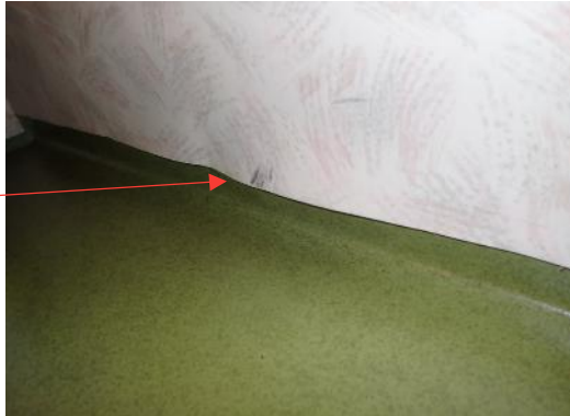
Kuva 71. Wc-tilan lattiamaton ylösnostot paikoin irti
