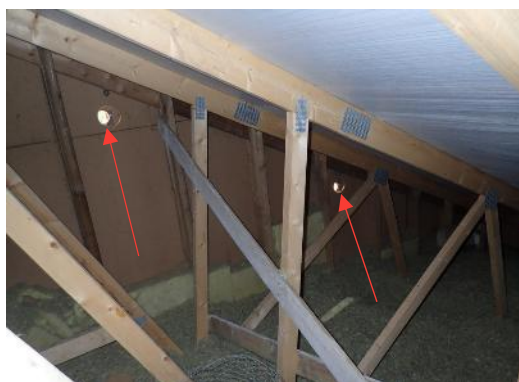
Kuva 49. Jälkikäteen tehtyjä tuuletusaukkoja
