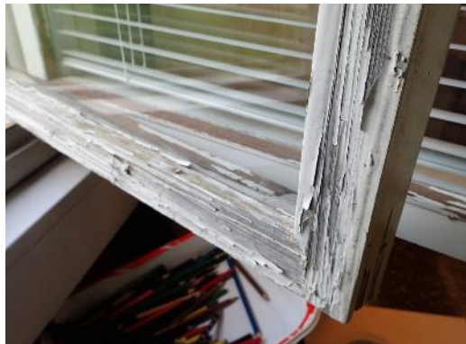
Kuva 35. Kolmipuitteisten ikkunoiden ulkopinnoilla maalipinnoitteet monin paikoin kuluneet
