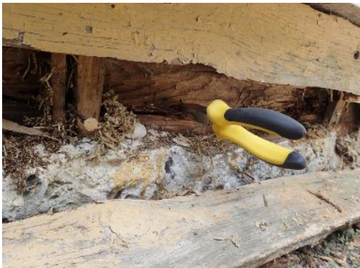
Kuva 22. Keltaisen rakennuksen alimmassa hirressä lahovaurioita
