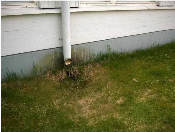
Kuva 3. Sadevesikaivojen kohdilla sadevesien roiskevedet ovat aiheuttaneet tummentumaa sokkelin pinnoille.
