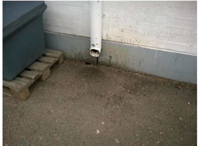
Kuva 4. Paikoin syöksyjen alapuolelle ei ole asennettu sadevesikaivoja..
