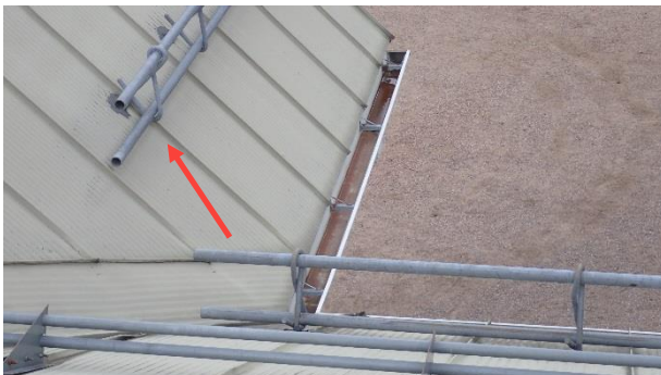
Kuva 33. Osa lumiesteistä on kiinnitetty vesikatteen läpi.
