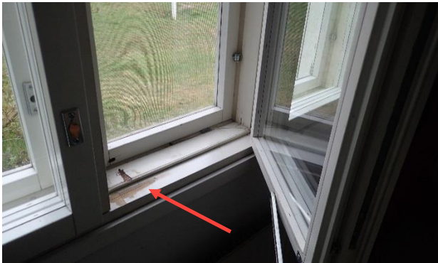
Kuva 28. Ikkunoiden maalipinta on paikoin kulunut. Havaintojen perusteella ikkunoiden tiiveydessä on puutteita.
