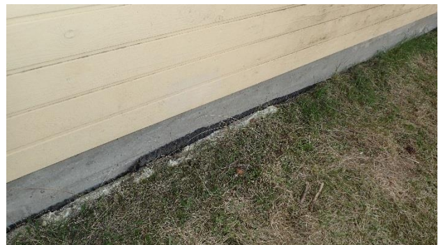
Kuva 6. Sokkelia vasten on asennettu patolevy sekä lämmöneristeeksi EPS-solumuovieriste. Patolevyn yläreuna ei ole tiivis sokkelia vasten.
