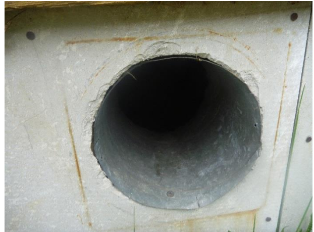
Kuva 47. Tuuletusluukku ryömintätilaan, Tuuletusluukun halkaisija noin 125 mm.
