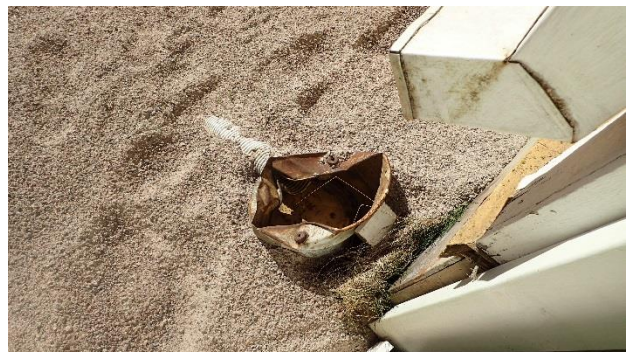
Kuva 43. Sadevesikaivo täysin kasaan painunut. Sadevesikaivo tehty maaliämpäristä.
