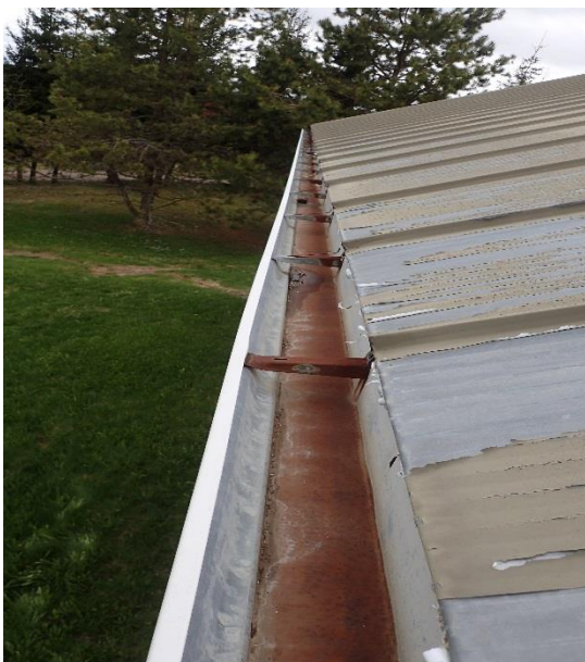
Kuva 39. Räystäskourut ovat ruosteessa.
