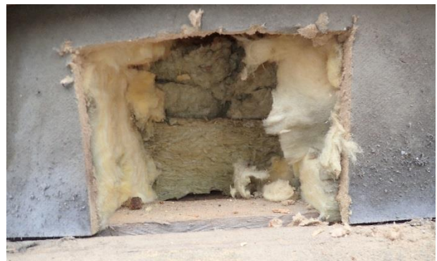
Kuva 61. RA7. Keittiön kohdalla alapohjarakenne on uusittu ja kutterinlastueriste korvattu mineraalivillalla. Mineraalivillaeristeen vaihdon laajuutta ei varmistettu.
