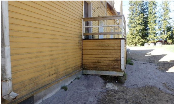
Kuva 66. Ulkoverhouksen alaosat ovat kosteusvaurioituneet rakennuksen pohjoissivulla.
