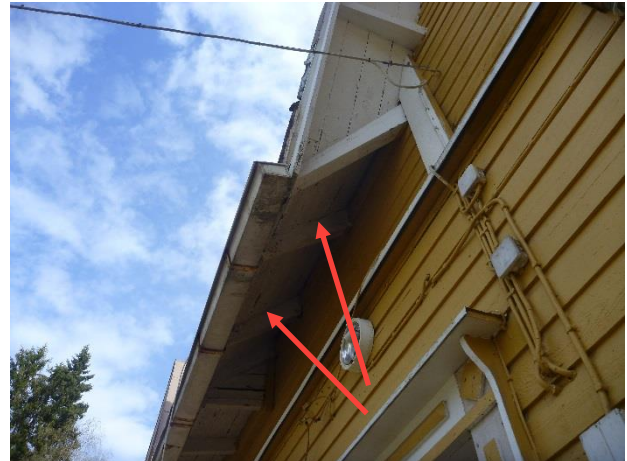
Kuva 93. Rästaiden alla havaittiin kosteuden aiheuttamia vaurioita.
