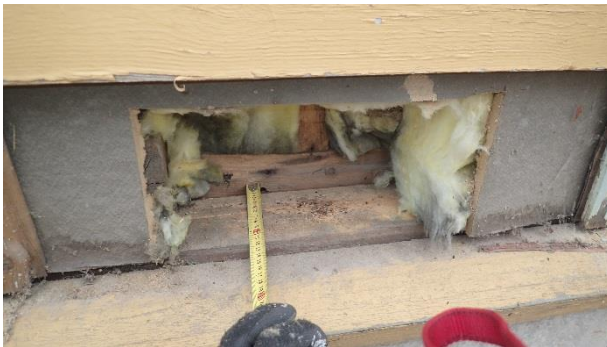
Kuva 64. RA6. Tuulensuojalevyn takana puukoolaus ja mineraalivilla 100 mm. Villassa on tummentumia.
