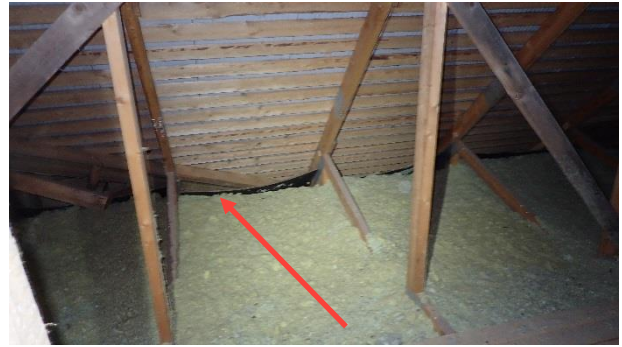
Kuva 32. Yläpohjan tuuleohjaimet ovat irronneet paikoin.
