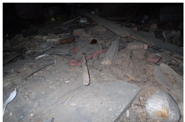
Kuva 51. Ryömintätilassa paikoin paljon roskaa ja jätettä.
