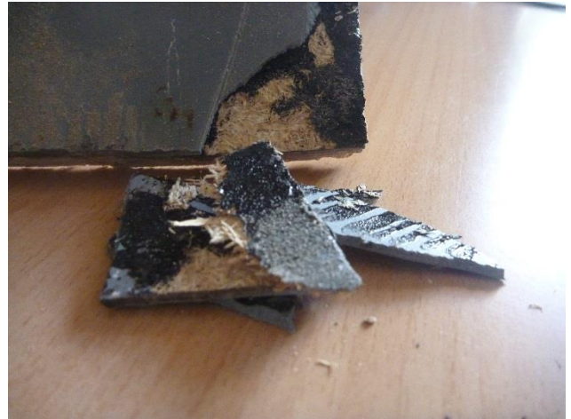
Kuva 95. Lattian vanha sininen vinyylilaatta ja musta liima sisältää asbestia krysotiili.
