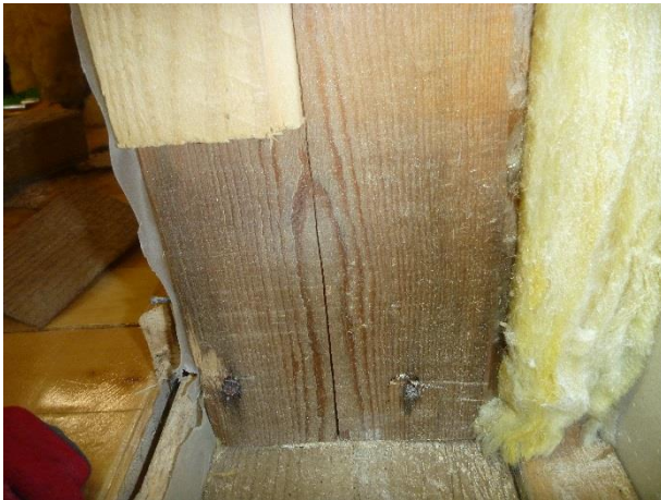
Kuva 22. RA2. Puurungon pinnalla ei havaittu vaurion merkkejä.
