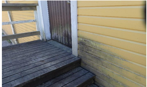
Kuva 67. Ulkoverhouksen alaosat ovat lahonneet rakennuksen pohjoissivulla.
