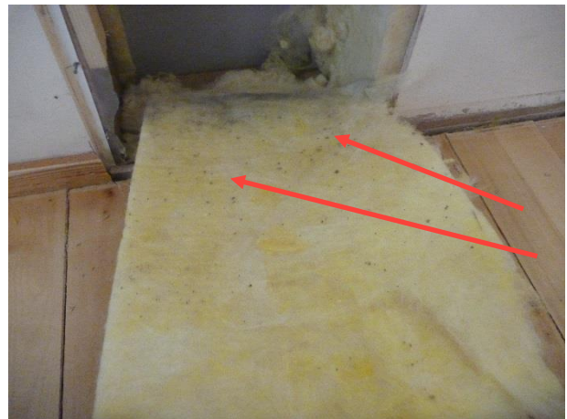
Kuva 19. RA2. Mineraalivillan ulkopinnalla tuulensuojalevyä vasten havaittiin tummentumaa.
