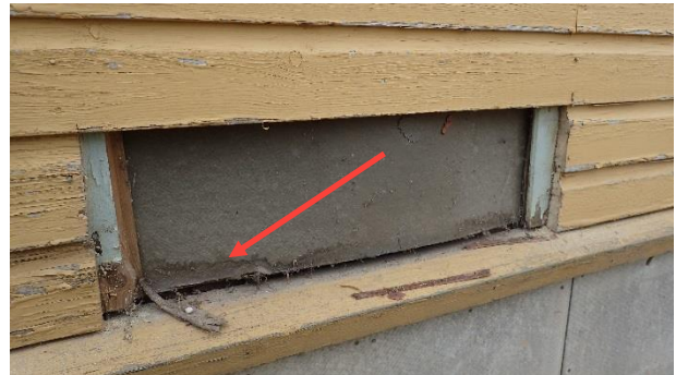
Kuva 63. RA6. Ulkoverhouksen takana on tuuletusväli ja tuulensuojalevy. Tuulensuojalevyn pinnalla kosteuspätkiä.
