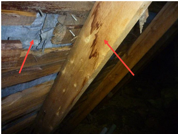
Kuva 86. Vesikattorakenteissa havattiin kosteuden aiheuttamia jälkiä. Aluskatetta ei ole.
