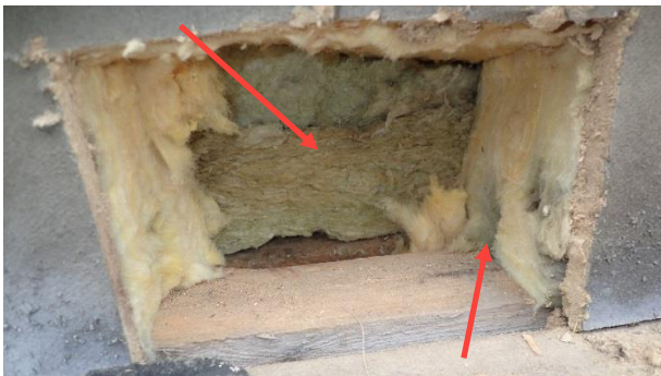
Kuva 70. RA7. Lattian kutterinlastu eriste on korvattu mineraalivillalla keittiön kohdalla. Ulkoseinän mineraalivillassa on tummentumia.
