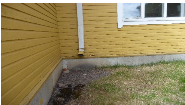
Kuva 44. Syöksyputkesta vesi valuu rakennuksen vierelle. Sokkelilevyssä havaittiin kosteusjälkiä.
