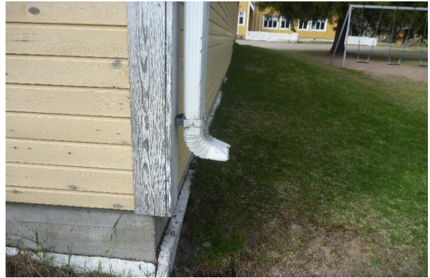
Kuva 27. Pielilautojen maalipinta on paikoin haalistunut.
