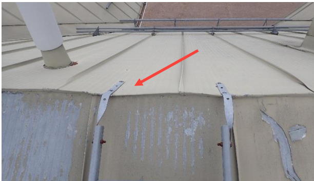
Kuva 37. Vesikaton pinta hilseilee yleisesti etelän puoleiselta lappeelta. Lapetikkaat on kiinnitetty vesikatteen läpi ilma tiivistettä.
