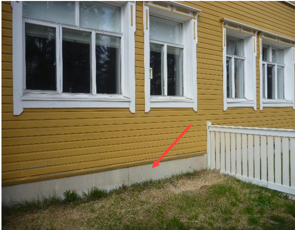
Kuva 94. Sokkelinkuitusementti levy sisältää asbestia krysotiili.
