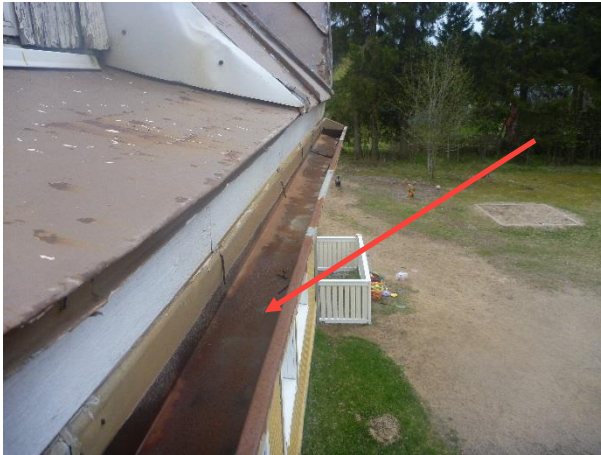
Kuva 92. Rästaskourut ovat yleisesti ruosteessa.
