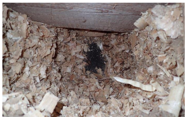
Kuva 57. RA8. Alapohjaeristeenä on kutterinlastu.
