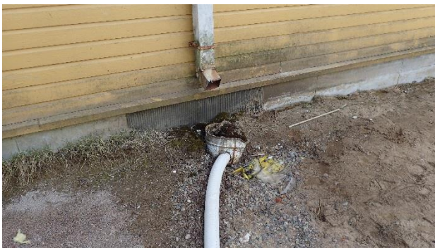
Kuva 42. Syöksyputkien alle on asennettu yksittäisiä sadevesikaivoja, jotka on tehty vanhoista maaliämpäreistä. Sadevesikaivojen kunto on heikko.
