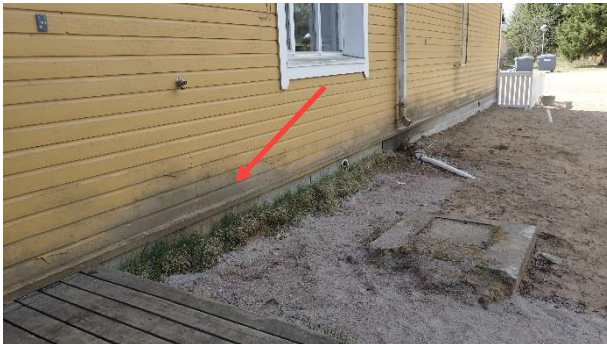
Kuva 68. Rakenneavaus RA7 tehtiin ulkoseinään keittiön kohdalle. Ulkoverhouksen alaosat ovat kosteusvaurioituneet.
