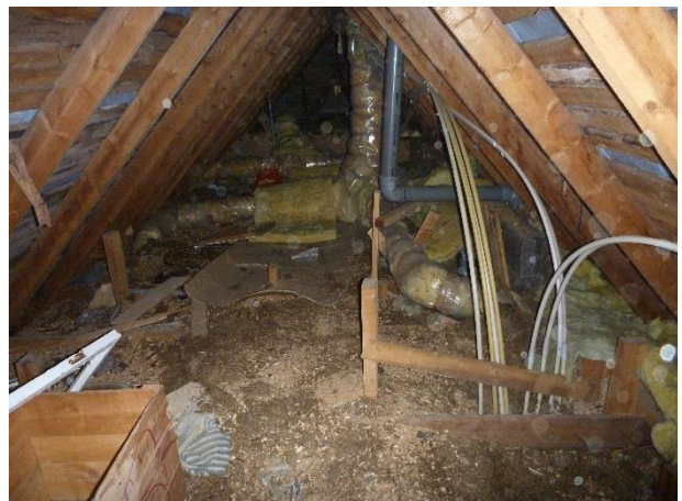
Kuva 85. Yleiskuva yläpohja- / ullakkotilasta. Yläpohjassa on tavaraa ja roskaa.
