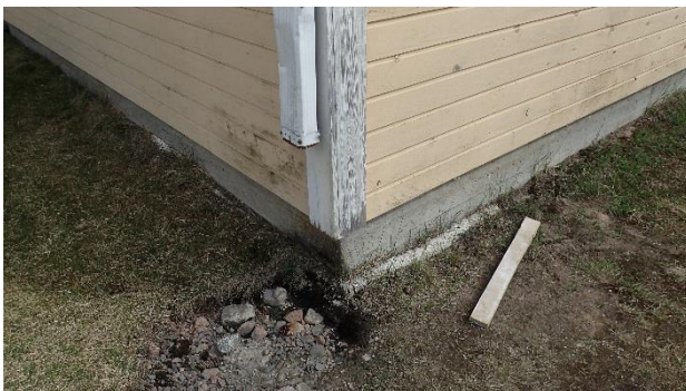
Kuva 5. Syöksyputkenpää on irronnut.
