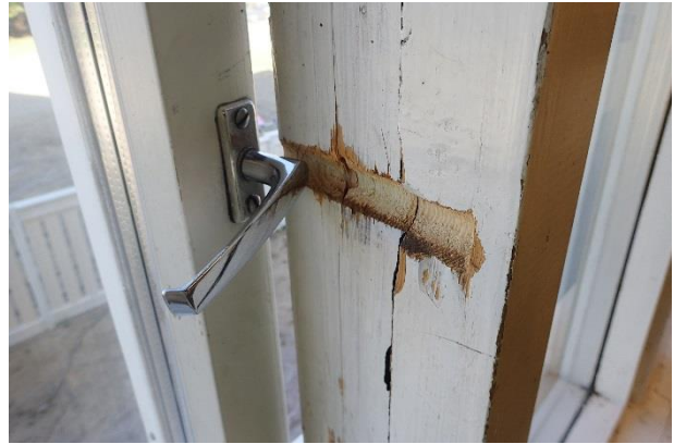
Kuva 79. Avattava lämpöikkuna ei ole tiivis.
