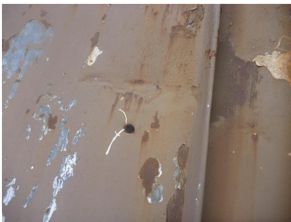
Kuva 90. Peltikatteessa haivattiin reikiä.
