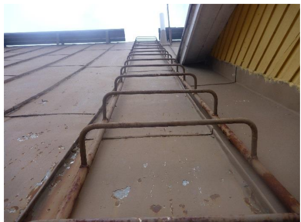
Kuva 91. Lapetikkaat ovat metallirakenteiset ja pinnalla on ruostetta.
