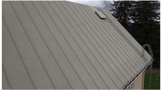
Kuva 36. Yläpohjatilaan on 2 kpl kattoluukkuja. Luukuille on asennettu asianmukaiset lapetikkaat. Nykyisen rakennusmääräyskokoelman mukaan korkean osan luukulle tulisi asentaa valjaskisko.
