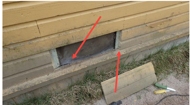
Kuva 69. RA6. Tuulensuojalevyn pinnalla kosteusjälkiä. Ulkoverhouksen tausta ei tuuletu.
