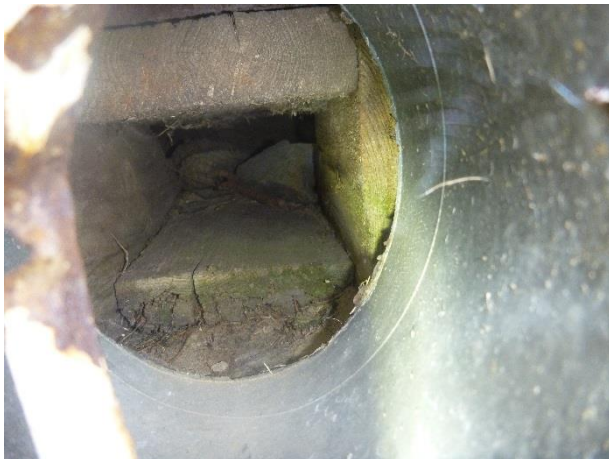
Kuva 52. Rakennuksen länsipäädyssä tuuletusluukut ovat tukossa.
