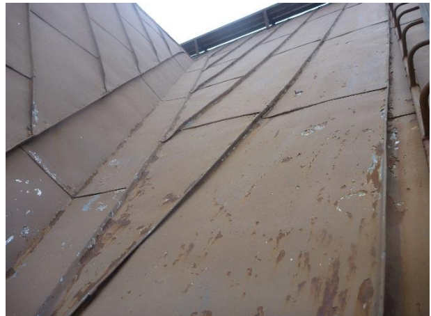
Kuva 89. Peltikatteen maalipinta hilseilee ja paikoin pellin pinnalla on ruostetta.
