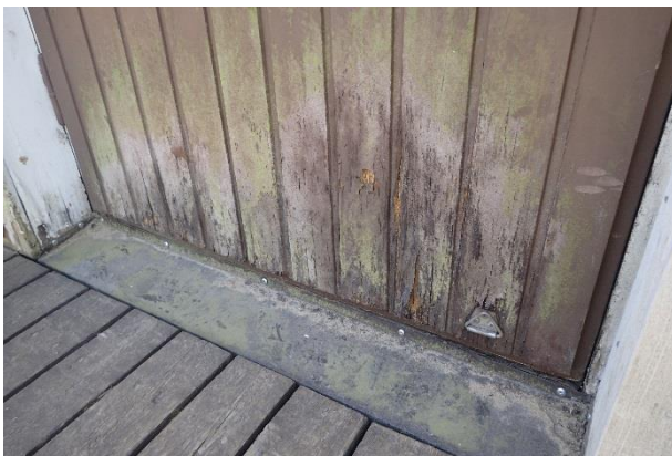
Kuva 76. Rakennuksen pohjoissivulla ulko-oven alaosa on kosteusvauriotunut.
