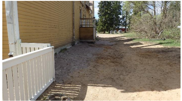
Kuva 41. Kuva rakennuksen takasivulta. Piha-alueen kallistus on loiva rakennuksesta pois päin. Kallistusta on pyritty parantamaan soralla.
