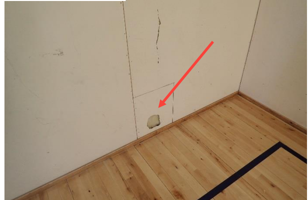
Kuva 17. RA2. Kuva rakenneavauksen kohdasta. Rakenneavauksen kohdalla sisäverhous levyssä oli reikä.
