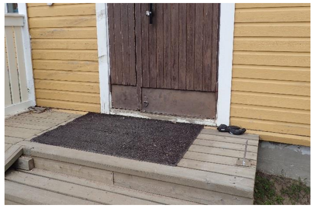
Kuva 77. Rakennuksen ulko-ovet ovat vanhoja ja puurakenteisia. Ovet eivät ole tiiviitä.
