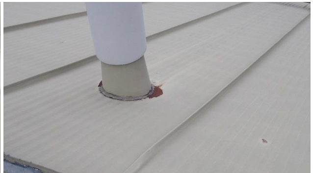
Kuva 38. Läpivientien tiivistyksissä havaittiin puutteita.
