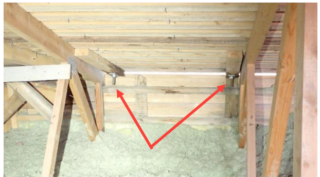
Kuva 34. Vesikatteen läpi kiinnitetyissä lumiesteiden kannatin kohdissa havaittiin kosteusjälkiä.
