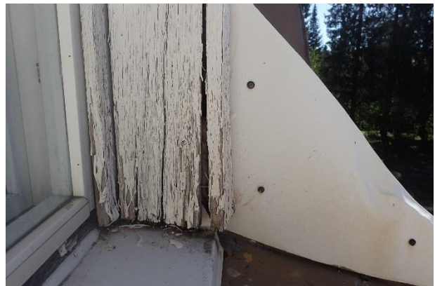
Kuva 81. Ikkunapuitteet ovat paikoin huonokuntoiset.
