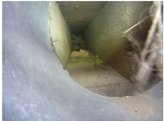
Kuva 53. Rakennuksen länsipäädyssä tuuletusluukut ovat tukossa.
