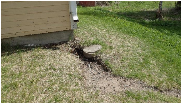
Kuva 3. Sadevedet on ohjattu rakennuksen vierelle. Vesi on kuljettanut maata pois syöksyputken alta.
