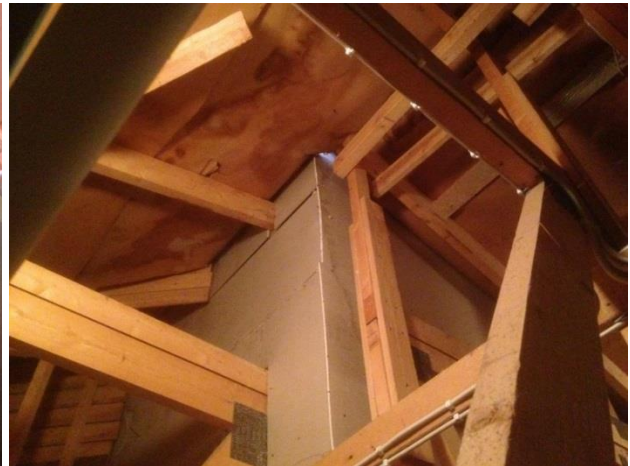
Kuva 8. Aluskatteen asennuksessa havaittiin puutteita myös vesikatteen läpivientien kohdilla.
