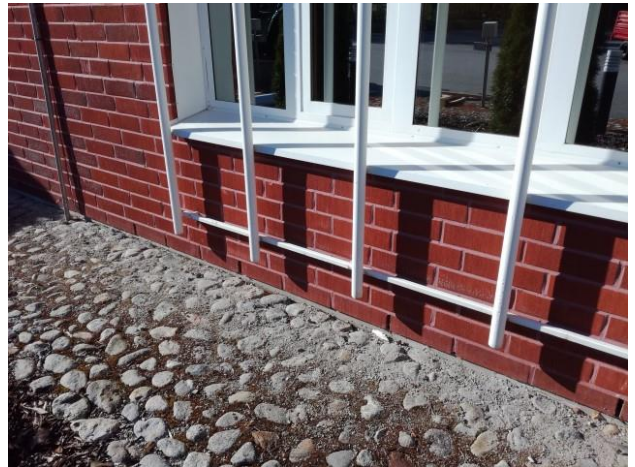
Kuva 2. Rakennuksen etusivulla sokkelipintaa ei ollut paikoin lainkaan näkyvillä.
