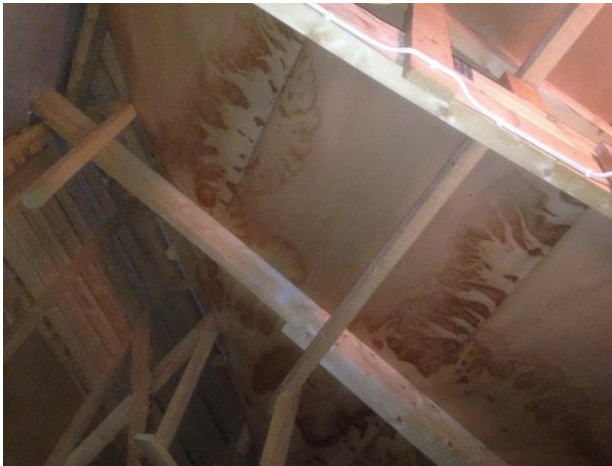
Kuva 7. Vesikatteen aluskate on asennettu puutteellisesti vesikaton jiirien kohdille.
