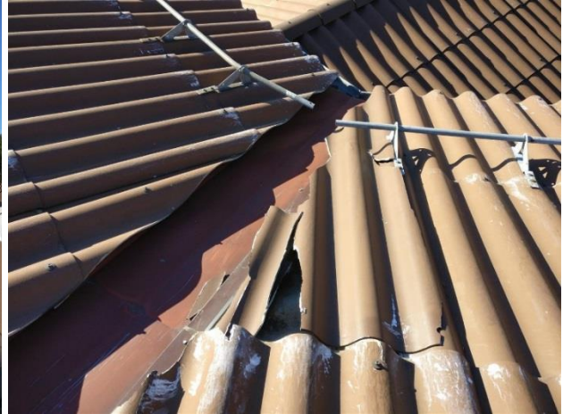
Kuva 6. Kate oli paikoin vaurioitunut vesikaton taitekohdilla.
