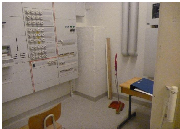
Kuva 15. Yleiskuva sähköpääkeskuksesta. Tilassa on maakellarin haju.
