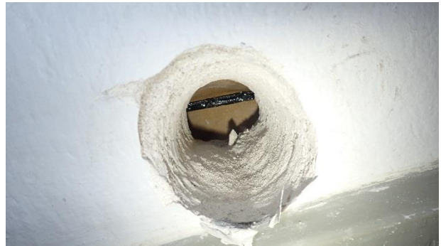
Kuva 25. RA7. Kuva rakennearauksesta. Sisäkuori betonia. Porattaessa betoni tuntui pehmeältä.
