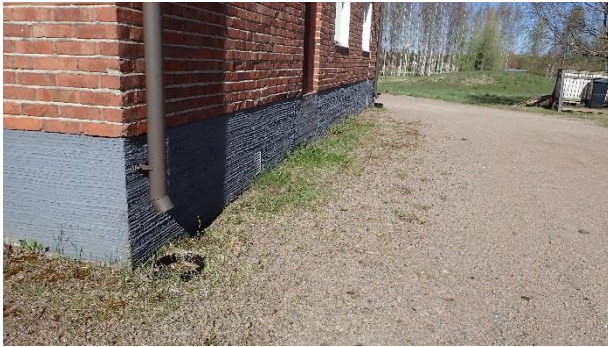
Kuva 5. Syöksyputken alla oleva rännikaivo on roskainen ja syöksyputkenpää on korkealla kaivoon nähden.
