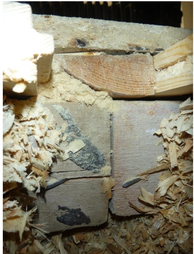
Kuva 45. RA8. Pintalattian rakenne liikuntasalin kohdalla. Rakenteessa ei ole ilmarakoa eristeen ja levyn välissä.
