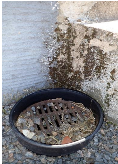
Kuva 6. Sadevesikaivo rakennuksen päädyssä hätäpoistumistien edessä. Kaivossa runsaasti kiviä ja roskaa.
