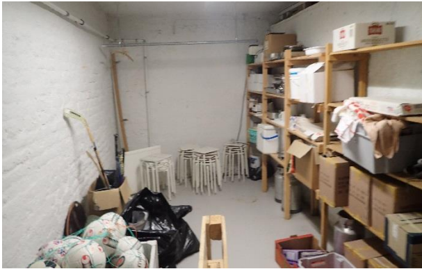
Kuva 8. Kellaritilassa, rakennuksen luoteispäädyssä havaittiin kohonneita pintakosteuslukemia.
