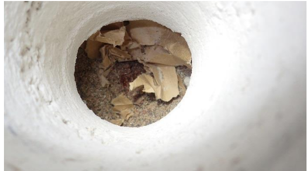
Kuva 40. RA3. Hiekan alla rakennuspaperi jolla hiekka ja eriste on erotettu toisistaan.
