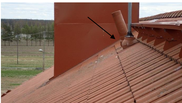
Kuva 48. Vesikaton läpivienneillä on tiilikatolle sopivat läpivienti kaulukset.
