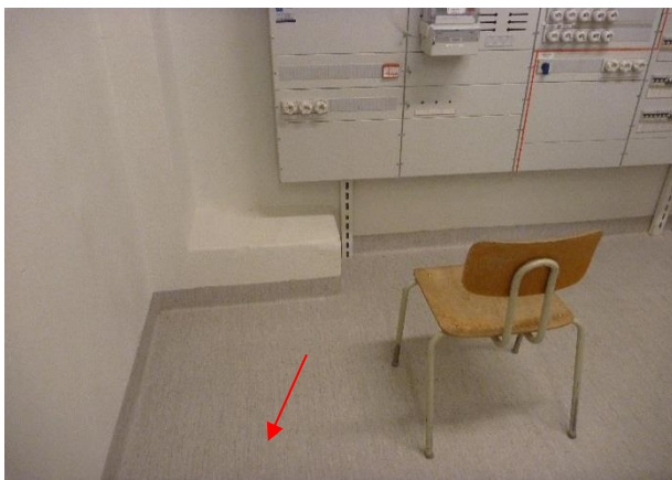
Kuva 14. Kuva sähköpääkeskuksesta. RA6 sähköpääkeskuksen lattiasta.
