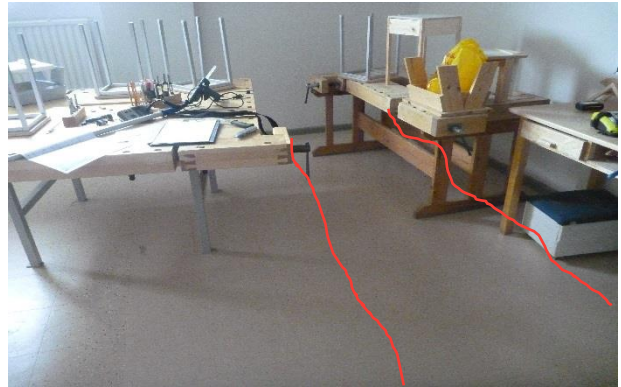
Kuva 9. Teknisentyönloukassa havaittiin lievästi kohonneita pintakosteuslukemia kapealla alueella. Vaurioita ei havaittu.
