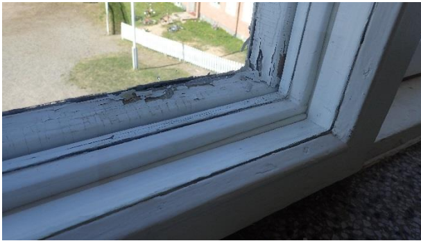
Kuva 26. Rakennuksen ikkunoiden maalipinta hilseilee yleisesti.
