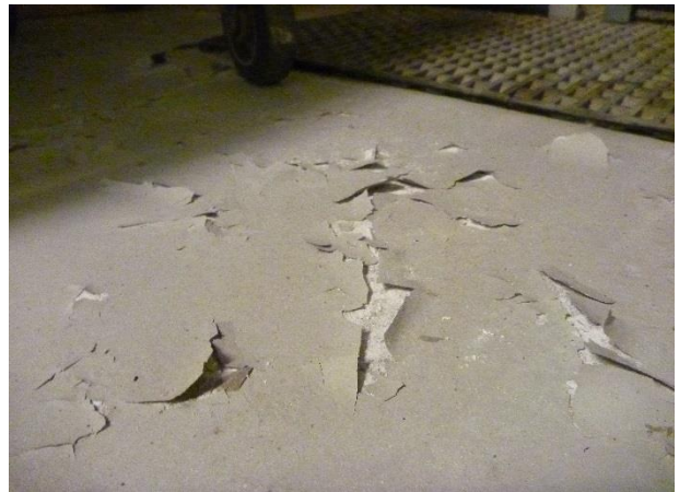
Kuva 11. RA4. Lattian pinnoite hilseilee rakenteen alapuolisen kosteuden vaikutuksesta. Pintakosteus lukemat olivat koholla.
