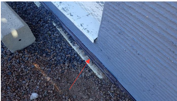
Kuva 7. Kuva rakennuksen etusivulta. Sokkelia vasten on asennettu patolevy sekä lisälämmöneristykseksi EPS-levy. Patolevyn yläreunassa ja sokkelin välissä on rakoilua.
