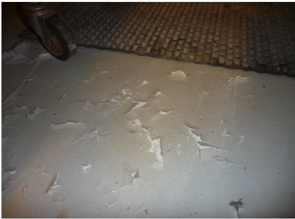
Kuva 10. RA4. Lattian pinnoite hilseilee rakenteen alapuolisen kosteuden vaikutuksesta. Pintakosteus lukemat olivat koholla.
