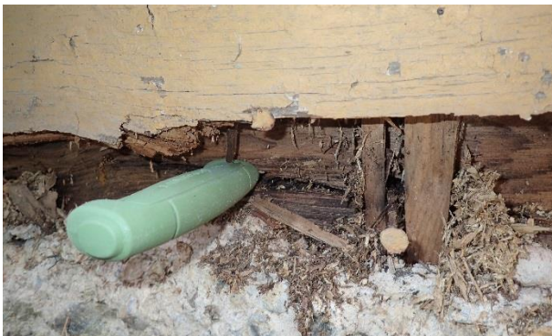
Kuva 46. Rakenneavauksen RA4 kohdalla alin hirsi on lahonnut.
