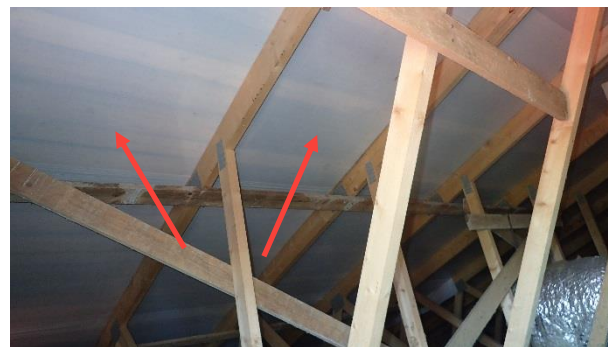
Kuva 27. Vesikatteen alla on aluskate. Aluskate on havaintojen mukaan asennettu virheellisesti liian tiukalle.
