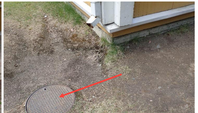
Kuva 33. Sadevedet on ohjattu rakennuksen vierelle. Kuvassa salojien tarkastuskaivo.
