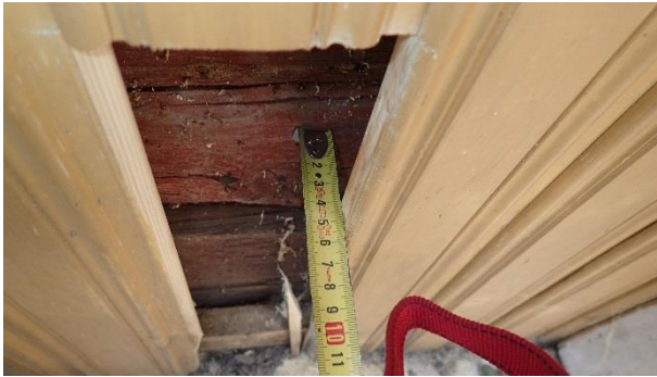
Kuva 44. RA4. Hirsirungon ulkopuolella ei ole lisälämmöneristystä.
