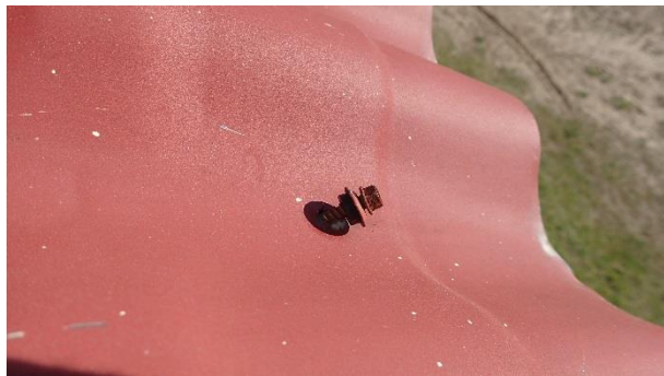
Kuva 25. Paikoin havaittiin irronneita kateruuveja.
