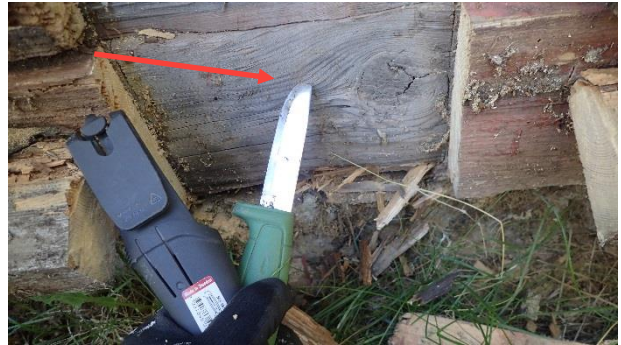
Kuva 90. RA16. Ylempänä lahoa ei havaittu.
