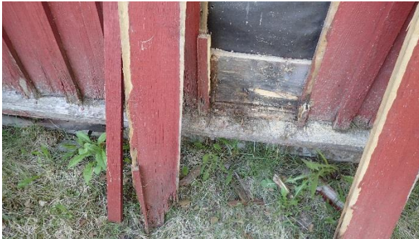
Kuva 87. RA16. Kuva rakenneavauksesta. Puuverhouksen alaosat ovat lahonneet.
