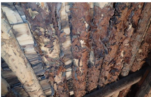
Kuva 69. Pärekatteessa havaittiin kosteusjälkiä. Puurakenteissa on puunkuoret paikoillaan mikä voi aiheuttaa puun lahoamista.
