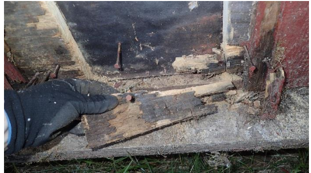
Kuva 88. RA16. Puuverhouksen alaosa on lahonnut.
