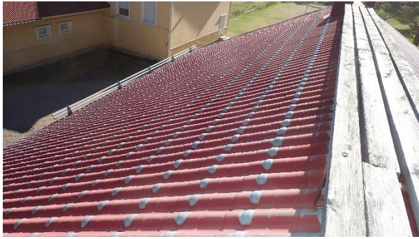
Kuva 71. Vesikatteen maalipinta on haalistunut ja kulunut.
