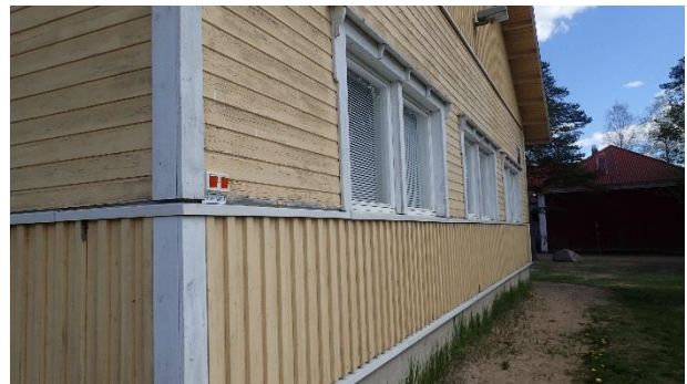
Kuva 17. Etelän ja lännen puoleisilla sivulla julkisivun maalipinta on yleisesti kulunut. Julkisivun ylä- ja alaosassa on lomalaudoitus sekä välissä vaakapanelointi.
