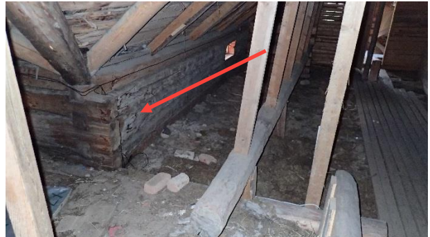
Kuva 113. Sisäjiirin kohdalla havaittiin kosteusjälkiä, jotka ovat todennäköisesti vanhoja.
