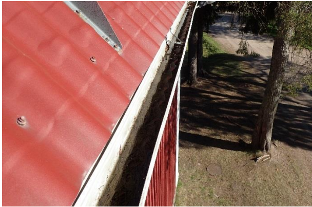
Kuva 118. Räystäskouruissa havaittiin roskaa. Lumiesteet on kiinnitetty peltikatteen läpi. Tiivisteitä ei kiinnityskohdissa havaittu.
