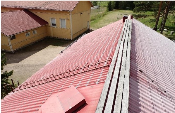
Kuva 65. Yläpohjan käyntiluukku on vesikatolla. Kulkusilta on puurakenteinen ja osin kiinnitykset ovat irronneet.
