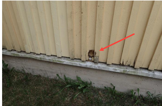
Kuva 19. Julkisivun alaosissa on paikoin lahoa ja yksittäisiä reikiä.
