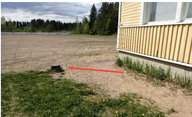
Kuva 5. Salaojituksen tarkastuskaivo on kohonnut maasta.
