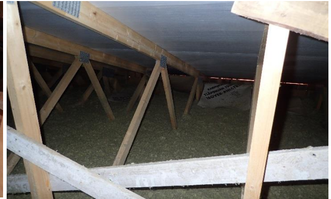
Kuva 29. Tuulenohjaimet ovat paikoin irronneet.
