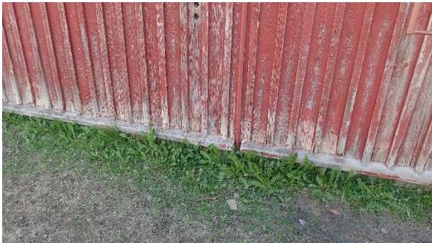
Kuva 99. Julkisivun alaosat ovat halkeilleet ja osin lahonneet. Alaosan kunto on huono.
