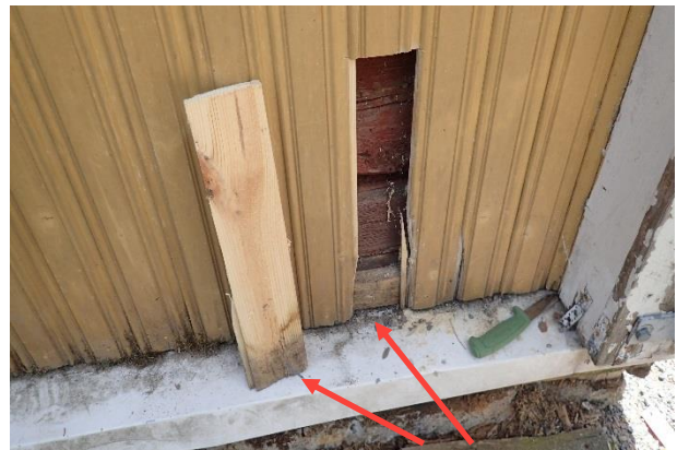
Kuva 43. RA4. Pystypaneloinnin takana koolaus ja kantava hirsirunko. Ulkoverhouksen tausta ei tuuletu. Ulkoverhouksessa on kosteusvaurioita.
