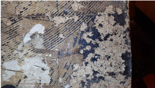
Kuva 105. RA14. Lastulevyn pinnalla mustaliima sisältää asbestia.
