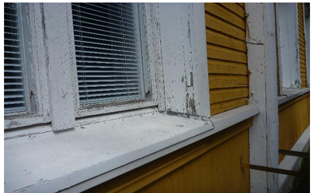
Kuva 59. Ikkunoiden puuosat ovat halkeilleet ja maalipinta on yleisesti hilseillyt
