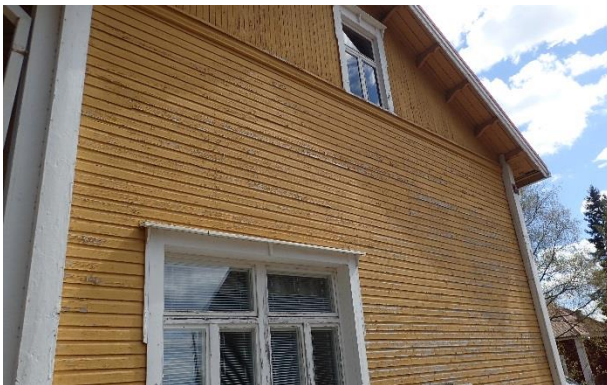
Kuva 58. Julkisivupaneloinnin maalipinta on yleisesti hilseillyt
