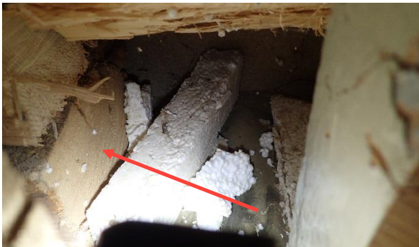
Kuva 63. RA10. Hirsirunkoa on lovettu rakenneavauksen kohdalta.
