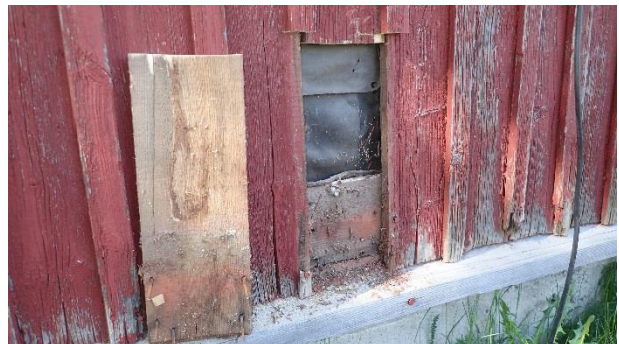
Kuva 94. RA17. Puuverhouksen alaosa on halkeillut ja lahonnut.
