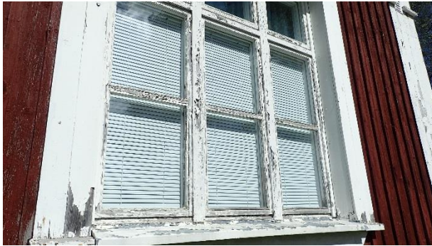
Kuva 101. Ikkunoiden ulkopuutteet ja pielilaudat ovat huonokuntoiset.
