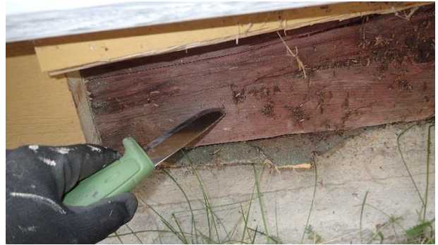
Kuva 51. RA9. Hirsi ei ollut avauksen kohdalla lahonnut.
