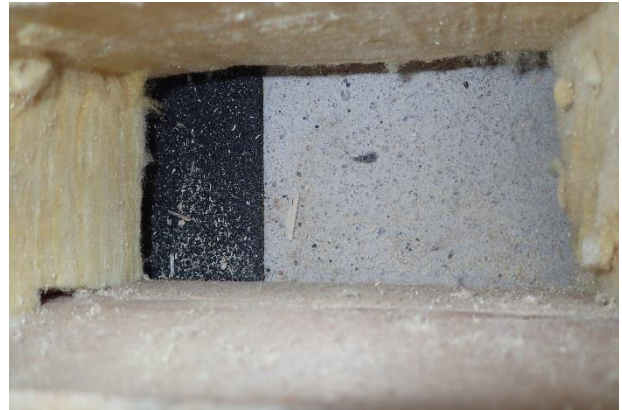
Kuva 9. RA2. Mineraavilla on hyväkuntoinen. Betonin ja lautakoolauksen välissä on mineraalivilla
