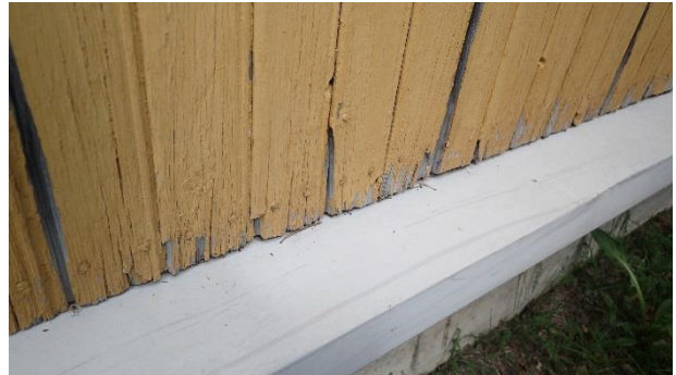
Kuva 57. Julkisivuverhouksen alaosat ovat yleisesti halkeilleet ja paikoin lahonneet.
