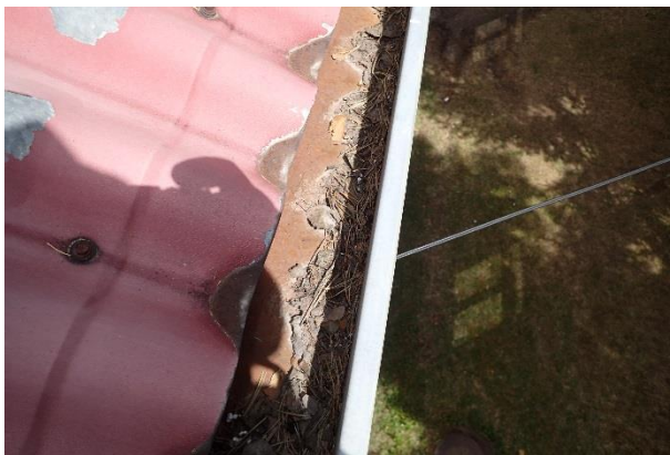
Kuva 73. Räystäskouruissa havaittiin roskaa ja ruostetta.
