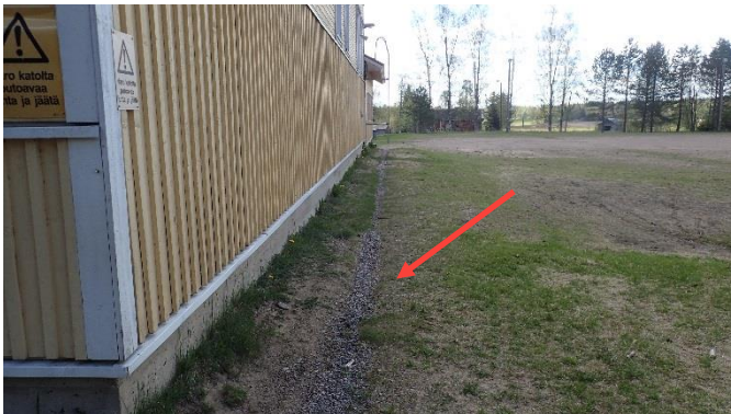
Kuva 3. Kuva rakennuksen takasivulta. Kattosadevedet valuvat vapaasti rakennuksen vierelle.
