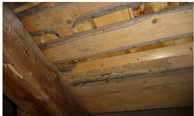
Kuva 111. Peltikaton alla on vanha pärekatto. Puurakenteissa havaittiin paikoin kosteusjälkiä. Merkittäviä vauriota ei havaittu.
