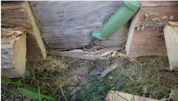
Kuva 89. RA16. Hirsirungon alareunassa on lahoa.
