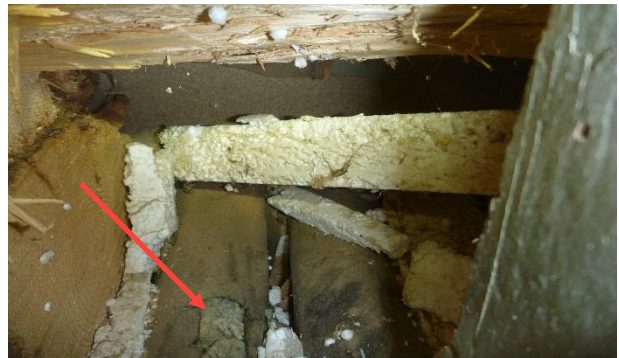
Kuva 64. RA10. Rakenneavauksen kohdalla havaittiin lattian alle asennetut vesiputkistot. Haitta-ainenäyte WVJ5 otettiin putken kartongista.
