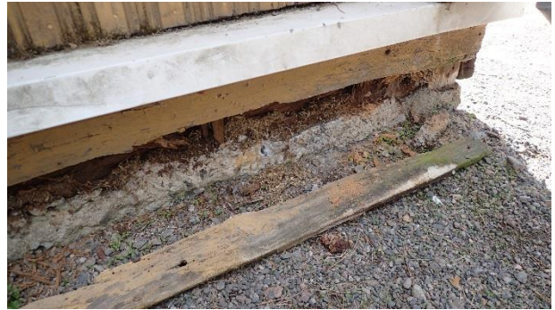
Kuva 45. Rakenneavauksen RA4 kohdalla laudoitus on lahonnut.
