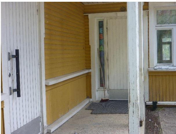
Kuva 60. Puurakenteiset ovet ovat tyydyttävässä kunnossa. Ovissa havaittiin tiivistys puutteita ja maalipinta on kulunut.
