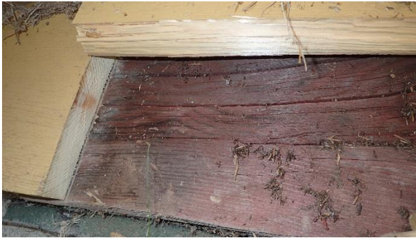
Kuva 50. RA9. Hirren pinnalla on kosteusjälkiä.
