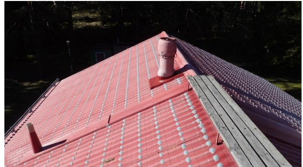
Kuva 72. Vesikatteen maalipinta on haalistunut ja kulunut. Läpivienneissä ei havaittu merkittäviä puutteita.
