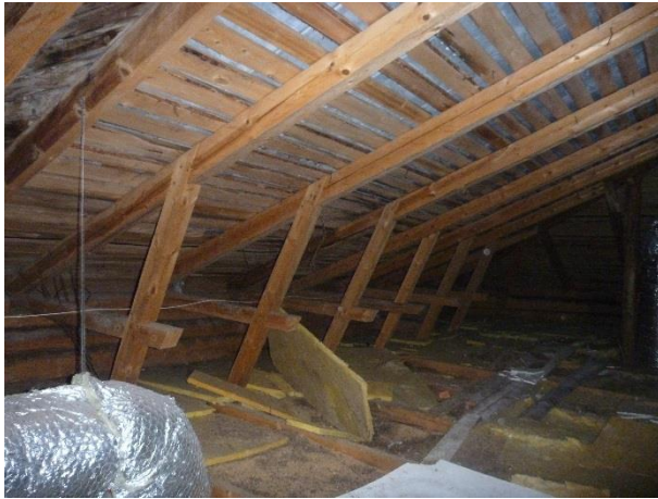
Kuva 57. Yleiskuva yläpohjatilasta. Vesikatteen alla ei ole aluskatetta
