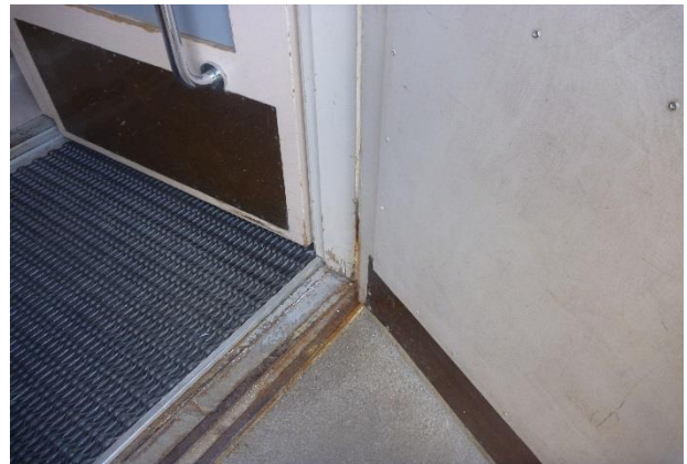
Kuva 40. Rakennuksen ulko-ovissa havaittiin tiivistys puutteita.
