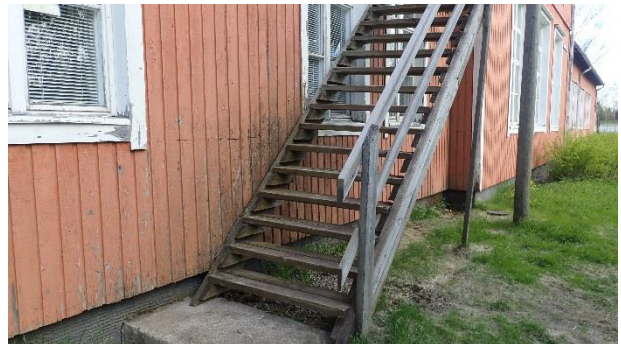
Kuva 36. Julkisivupanelointi on kosteusvaurioitunut portaiden takana. Portaat toimivat hätäuloskäyntinä teknisentyötilasta. Portaat ovat huonokuntoiset.
