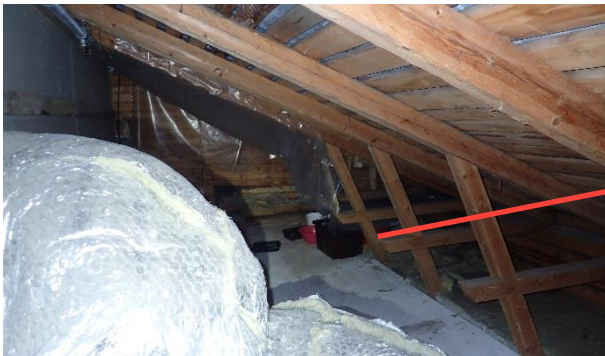
Kuva 63. Yläpohjatilaan on laitettu muovia sekä sankkoja keräämään vuotovesiä.
