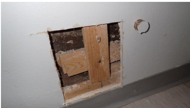
Kuva 21. RA2. Hirsirungon sisäpuolelle on asennettu puukoolaus ja kipsilevy. Rakenneavauksen kohdalla koolauksessa on ureaformaldehydi lisäeristys. Eristys on osin hävinnyt.
