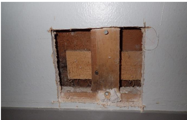
Kuva 27. RA4. Rakenneavauksen kohdalla ei havaittu lisälämmöneristystä.
