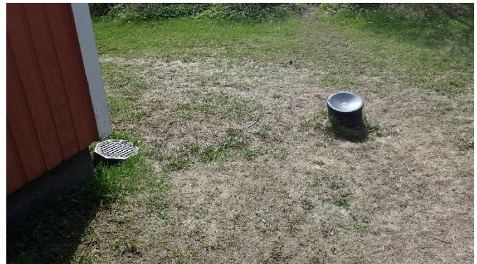
Kuva 4. Rakennuksen vierelle on asennettu salaojitukset. Tarkastuskaivo on kohonnut maasta ja putket ovat virheellisessä korkeudessa. Salaojitus ei arviolta ole toimiva.
