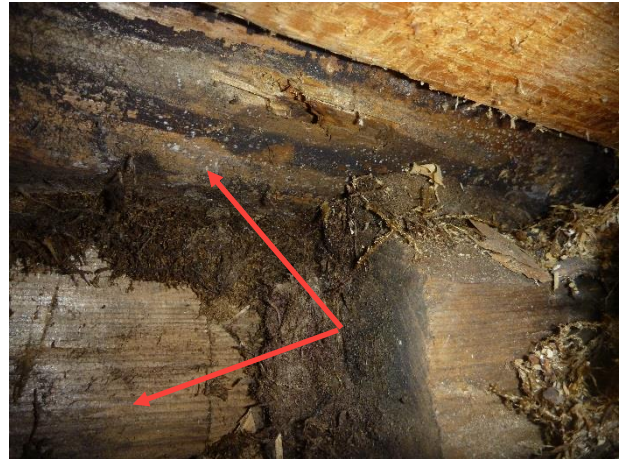
Kuva 56. RA13. Kuva ulkoseinän hirsirungosta välipohjan sisällä. Hirsirungon pinnalla havaittiin kosteuden aiheuttamia jälkiä.
