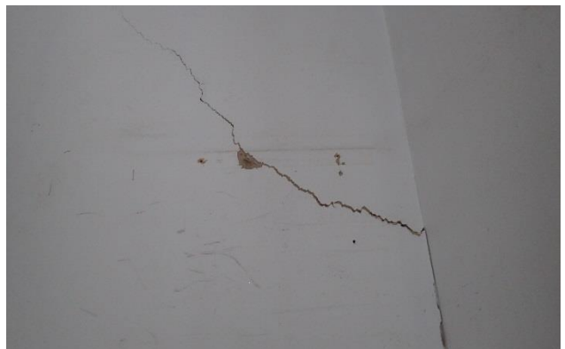
Kuva 74. Akustiikkalevyissä havaittiin vaurioita joista voi irrota villakuituja huoneilmaan.
