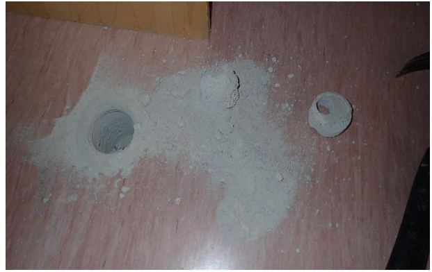
Kuva 12. RA9. Rakennavauksen kohdalla alapohjan pintalaatta oli haurasta.
