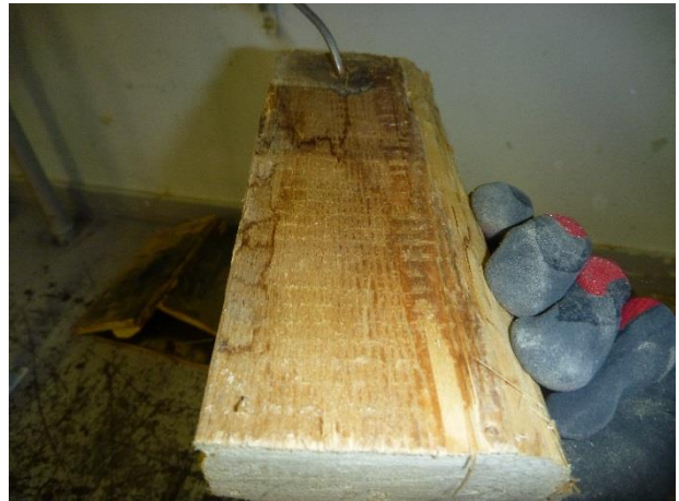
Kuva 52. RA13. Levyjen alla on alkuperäinen ponttilauta. Ponttilaudan alapinnalla havaittiin kosteuden aiheuttamia jälkiä.
