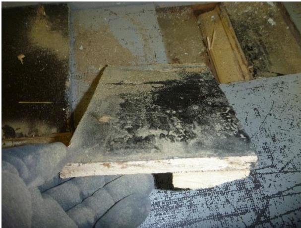
Kuva 51. RA13. Filmivanerin alla on lastulevy. Lastulevyn pinnalla on asbestia sisältävä bitumiliima.
