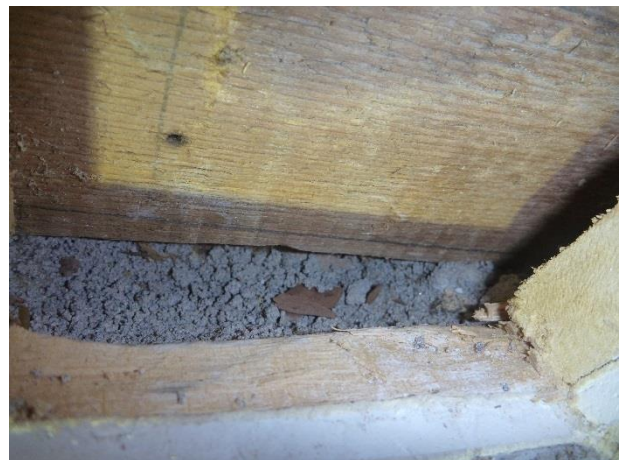
Kuva 44. RA11. Lattiarakenteen betoni ulottuu hirsiseinää vasten.
