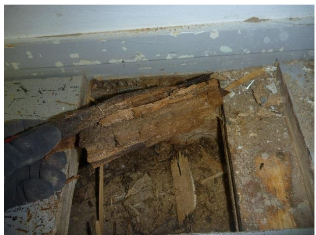
Kuva 54. RA13. Välipohjaeristeen seassa havaittiin lahonnutta puuta.
