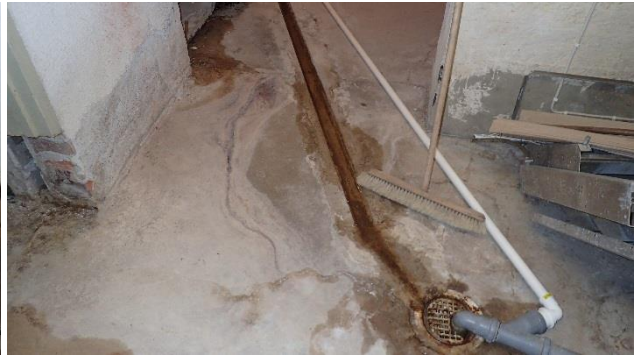
Kuva 70. Kellaritilan lattia oli märkä.
