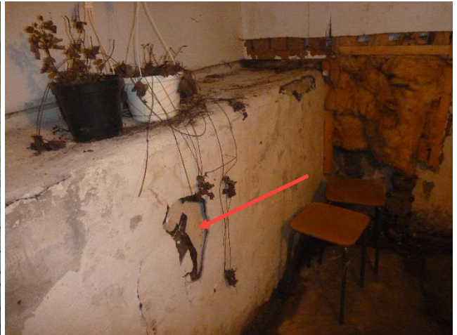
Kuva 68. Kellarinseinän bitumieriste sisältää asbestia antofylliitti.
