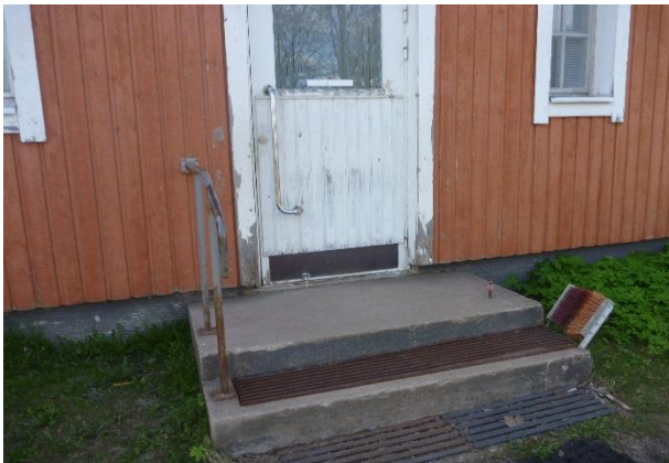
Kuva 39. Rakennuksen ulko-ovet ovat huonokuntoiset.
