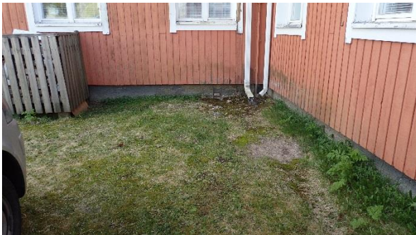
Kuva 35. Julkisivupanelointi on kosteusvaurioitunut nurkan vierellä.
