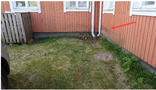
Kuva 1. Maanpinta on tasainen. Kattosadevedet on johdettu sadevesikaivoon. Julkisivun pinta on kosteusvaurioitunut nurkan kohdalla.
