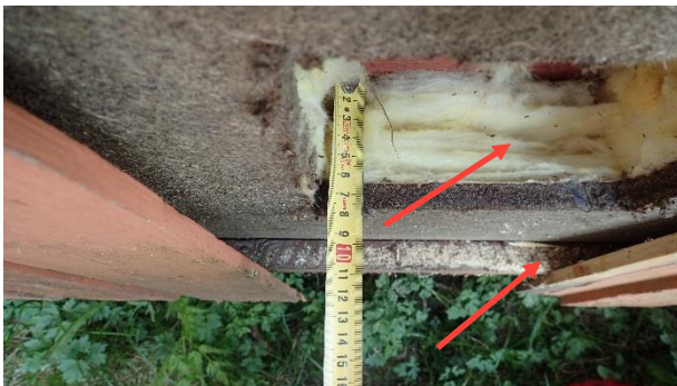
Kuva 19. RA1. Hirsirunko on lisälämmöneristetty mineraalivillalla. Rakenteessa ei ole tuuletusväliä.
