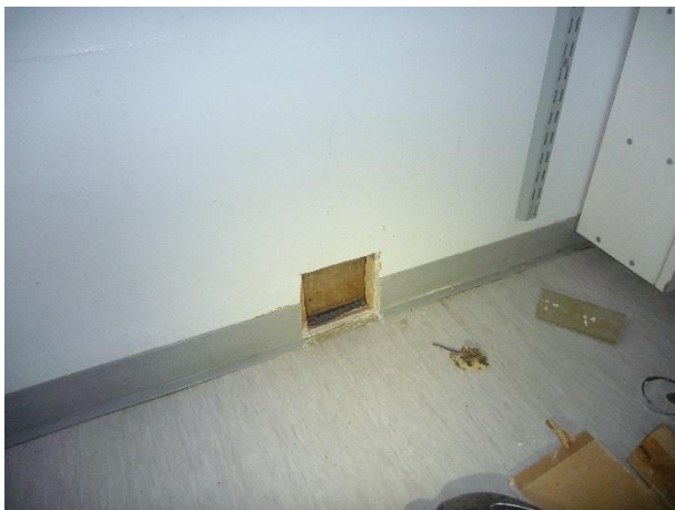
Kuva 43. Rakenneavaus RA11. Rakenneavaus kantavaan väliseinään tehtiin lattian rajaan. Avauksessa havaittiin tunkkaista hajua.
