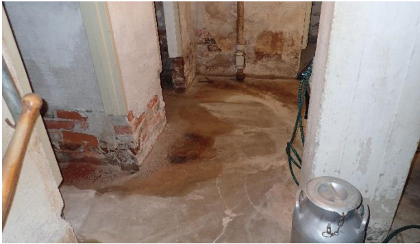
Kuva 69. Kellaritilan lattia oli märkä.
