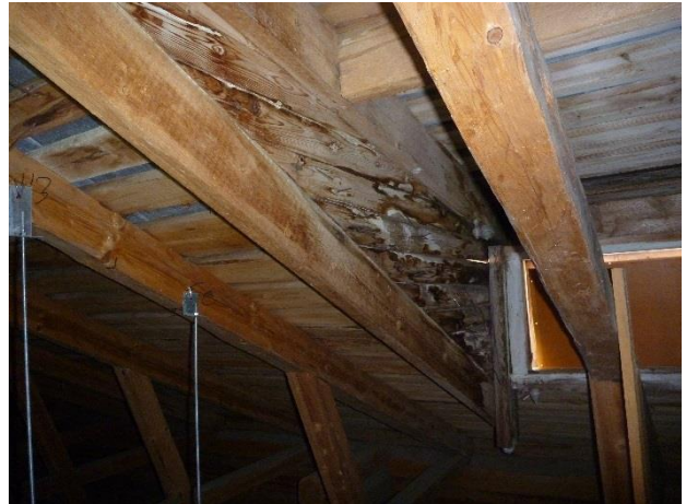
Kuva 60. Vesikattorakenteissa havaittiin useita kosteusjälkiä ja vuotoaikoja.
