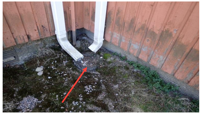
Kuva 2. Osin kattosadevedet on johdettu sadevesikaivoihin. Kaivo on roskainen.
