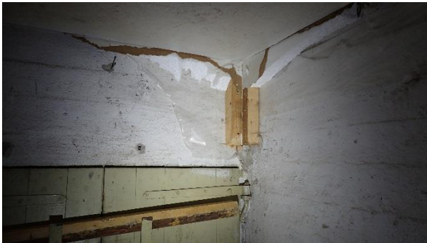
Kuva 71. Kellaritilan seinä pinnoitteita on osin purettu. Suositeltavaa on purkaa kaikki orgaaninen materiaali.
