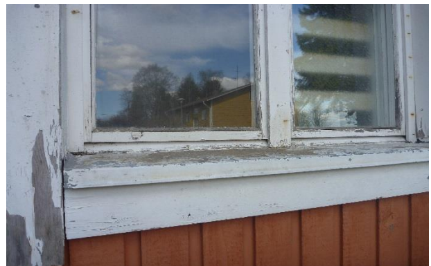
Kuva 42. Ikkunoiden puurakenteissa havaittiin halkeilua ja maalipinta hilseilee kauttaaltaan.
