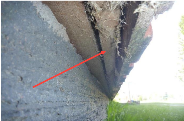
Kuva 23. Ulkoverhouksen takana ei ole tuuletusväliä.
