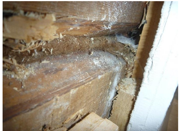
Kuva 48. RA12. Hirsirungon pinnalla havaittiin sienirihmasto.
