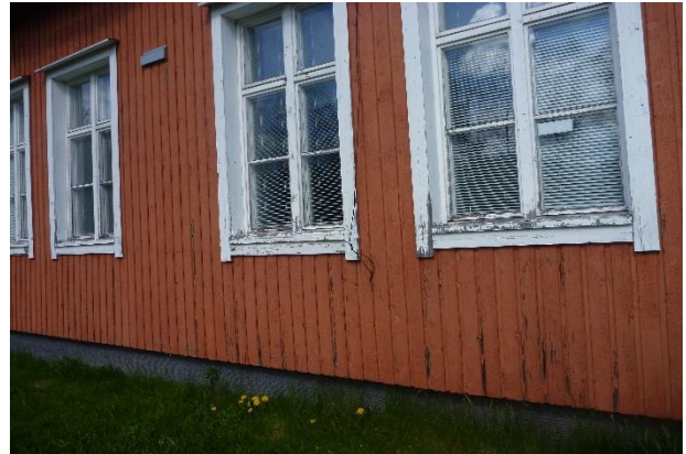
Kuva 38. Julkisivun maalipinta hilseilee kauttaaltaan ja on paikoin lahonnut.
