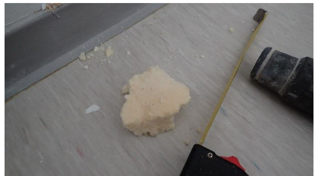
Kuva 22. RA2. Kuva ureaformaldehydi eristyksestä. Eriste on haurasta ja se häviää yleisesti rakenteesta.
