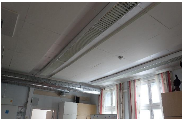
Kuva 73. Sisäkattoon on asennettu mineraalivillasta valmistettuja akustiikkalevyjä.
