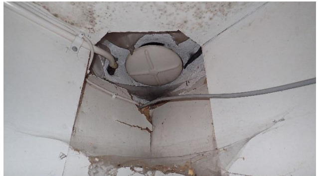
Kuva 72. Kellaritilasta on hormirakenteita joiden kautta voi kulkeutua epäpuhdasta ilmaa käytössä oleviin tiloihin mikäli rakenteet ovat yhteydessä toisiinsa.
