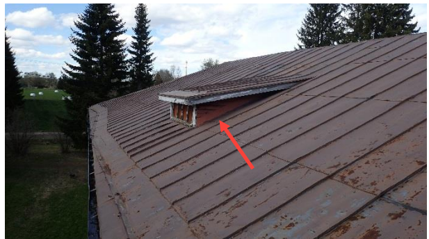
Kuva 66. Kattoikkunoiden kohdalla havaittiin yleisesti vuotokohtia. Katteen pinnalla on kauttaaltaan ruostetta sekä maalipinta hilseilee.
