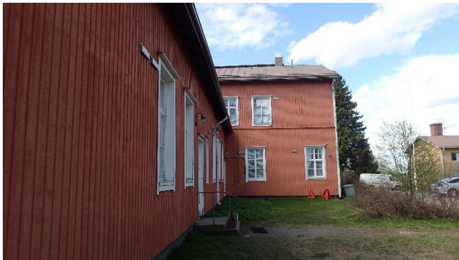
Kuva 3. Maanpinta on tasainen rakennuksen vierellä ja paikoin kallistus on rakennusta kohti.
