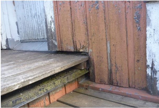
Kuva 37. Julkisivu on huonokuntoinen teknisentyötilan hätäpoistumisoven vierellä. Myös ovi on huonokuntoinen.
