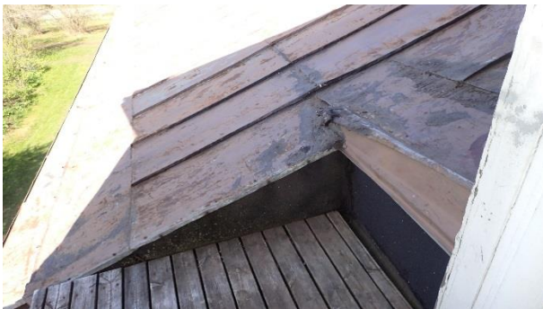
Kuva 65. Vuotokohta vesikatolla on teknisentyön luokan varatien kohdalla.
