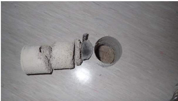
Kuva 15. RA10. Kuva pintalaatasta. Pintalaatan ja tojax-levyn välissä on rakennusmuovi.
