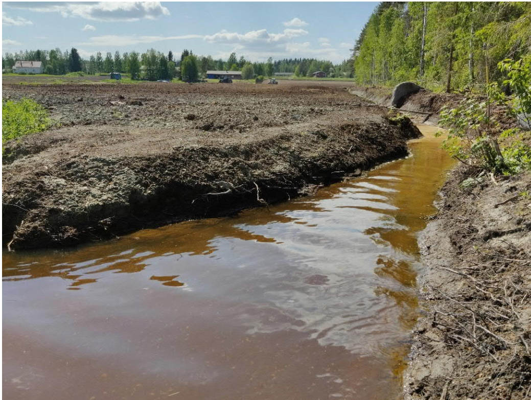
Kuva 13. Pellon muokkaustyöt olivat käynnissä kesäkuun alussa (8.6.2021) Pajulanojan kuppeessa. Pajulanojan uoma oli myös juuri kaivettu auki, sillä uoman reunoilla ei esiintynyt lainkaan kasvillisuutta.
